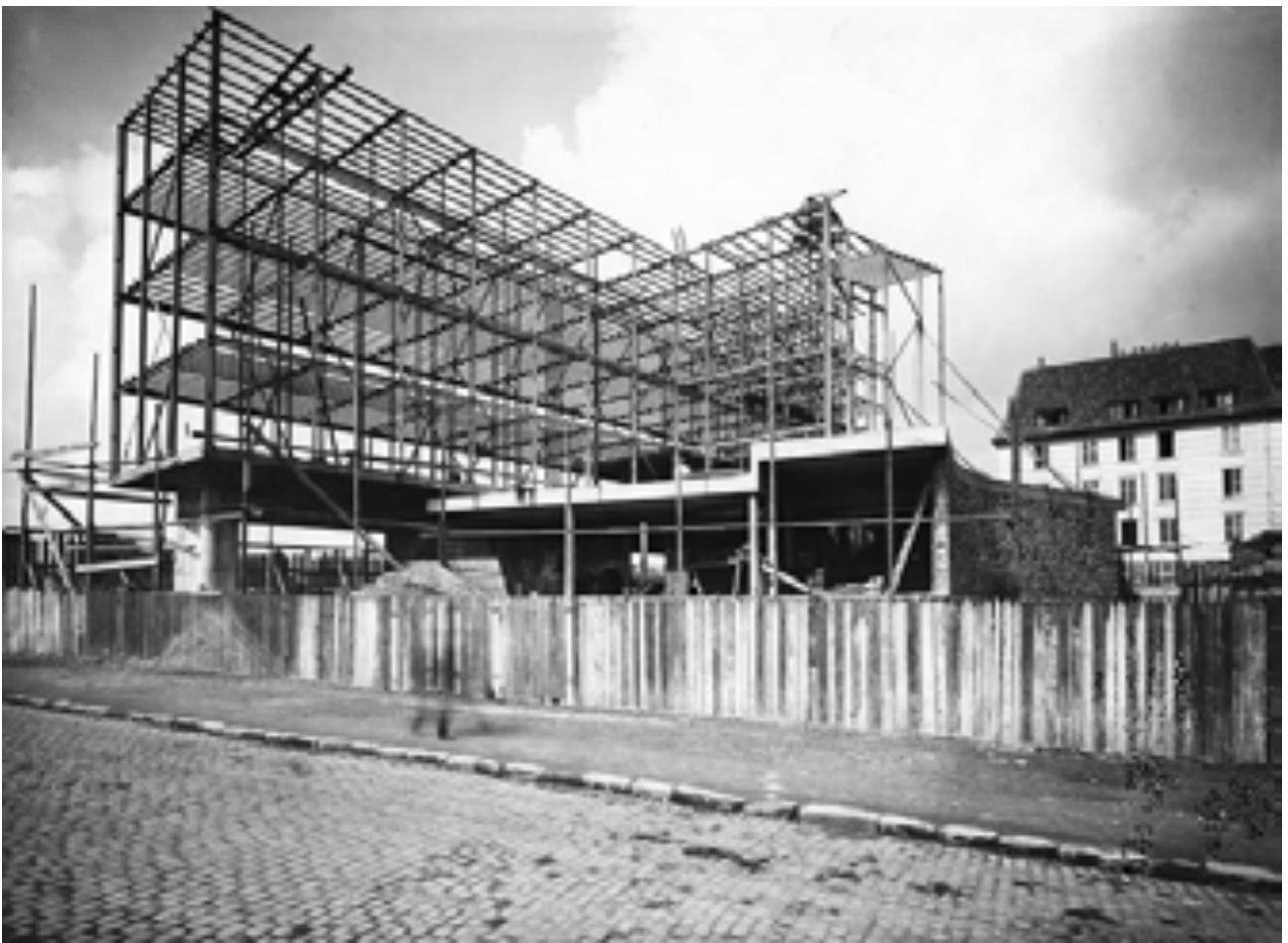
Le Corbusier, Pabellón Suizo de la Ciudad Universitaria . Paris, 1930-32. Entramado metálico en construcción.
