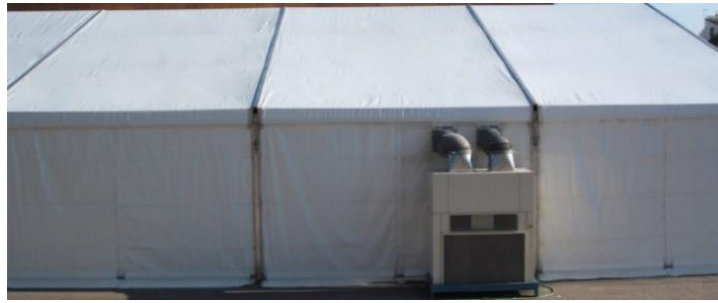
ILUSTRACIÓN 20: REFRIGERACIÓN INDUSTRIAL EN UNA CARPA (1)
