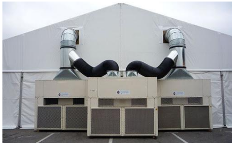
ILUSTRACIÓN 21: REFRIGERACIÓN INDUSTRIAL EN UNA CARPA (2)
