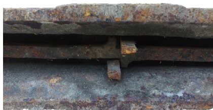
Figura 54. Detalle del mecanismo interno de la base y manchas blanquecinas.
