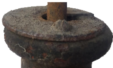
Figura 65. Detalle de la pulverulencia yacente sobre la obra.
