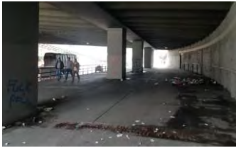
Pasaje bajo el puente en Teusaquillo en estado de suciedad y deterioro. (Fuente: Bicistema).
