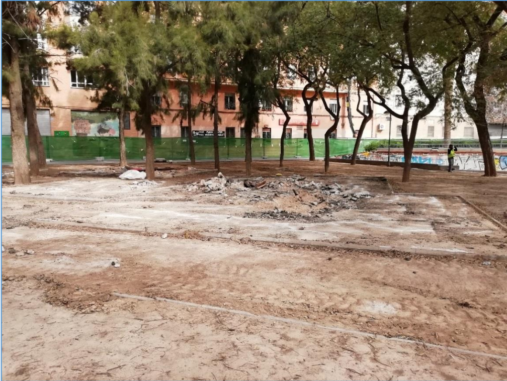
Imagen 7. Zona de columpios desmantelada.
