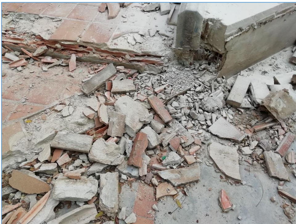
Imagen 18. Escombros de la zona de la fuente.
