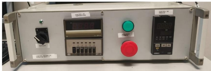
Figura 3.7 Imagen caja controladora de carro de inyección
