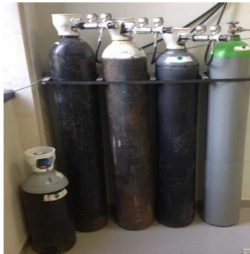
Figura 3.5 Instalación aire comprimido
