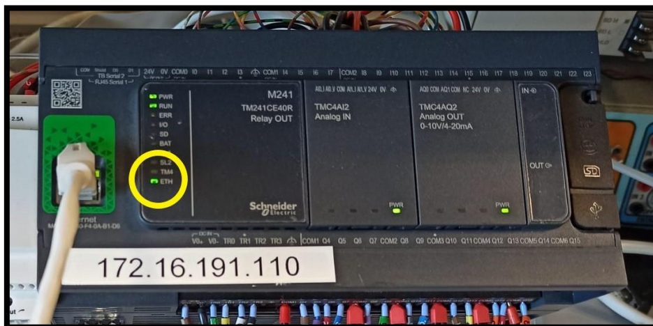
Ilustración 41. Comprobación conexión Ethernet LEDs PLC M241
