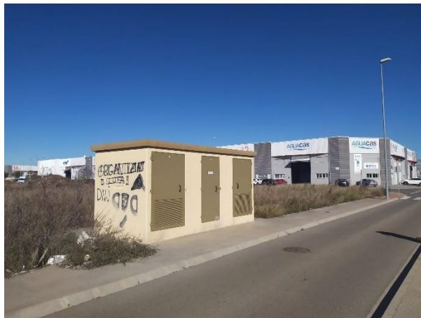
Fotografía 7: Transformador situado en la C/Cuadra Morteras.
