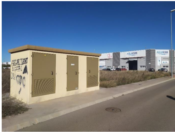
Fotografía 6: Transformador en Calle Cuadra Morteras
