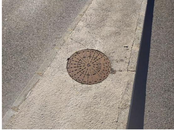
Fotografía 6: Tapa de drenaje situada en C/Cuadra Morteras
