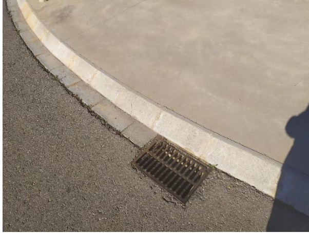
Fotografía 4: Hilera de imbornales situado en C/Polonia
