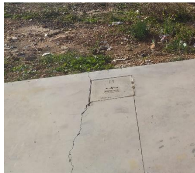
Fotografía 9: Arqueta de Telefónica situada en la C/Polonia.
