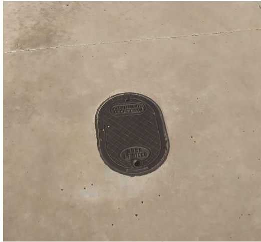
Fotografía 10: Boca de riego en la C/ Cuadra Morteras.
