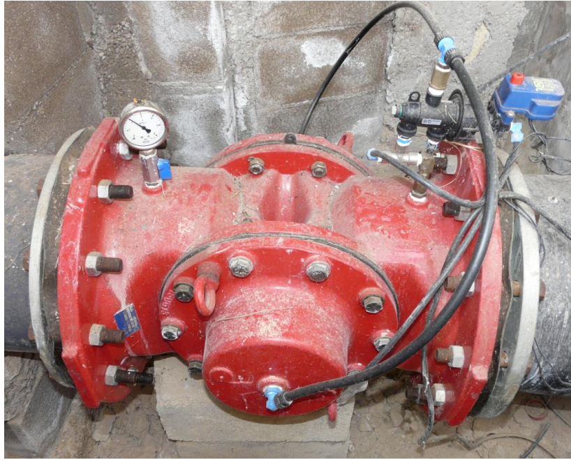
Figura 19: Válvula de doble membrana, conectada a la salida del cabezal Corral y empleada en caso de riego de la red 1.2 por bombeo para mantener la presión aguas arriba
