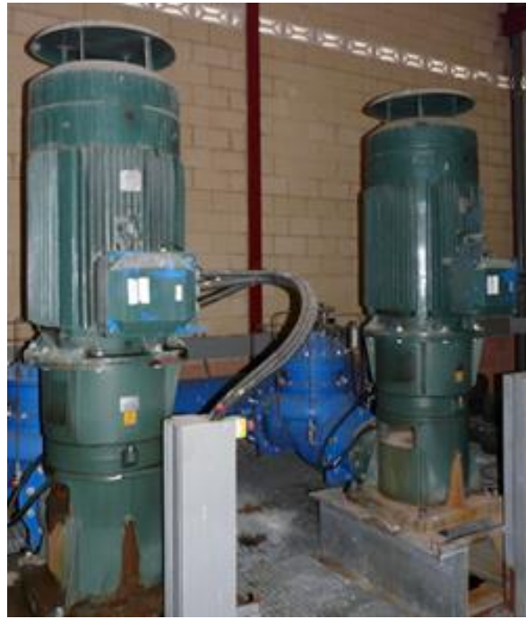
Figura 4: Bombas centrífugas de eje vertical conectadas en paralelo
