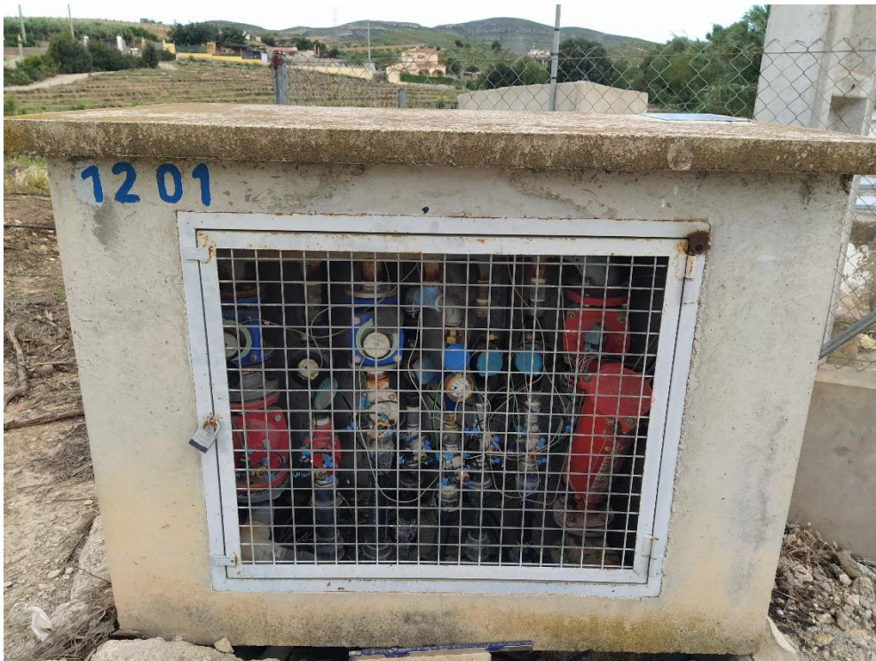
Figura 20: Vista de un hidrante multiusuario (H-1201)
