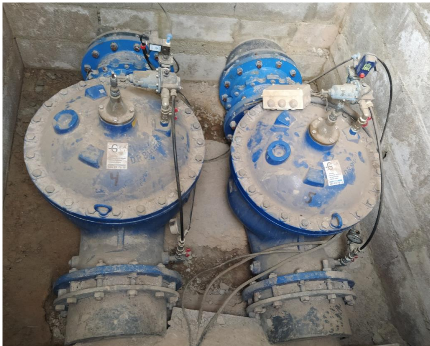
Figura 18: Válvulas reductoras de presión asociadas a la red 1, empleadas en el riego del sector 3
