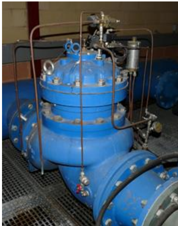
Figura 5: Válvula de control de bombeo a la salida de la bomba
