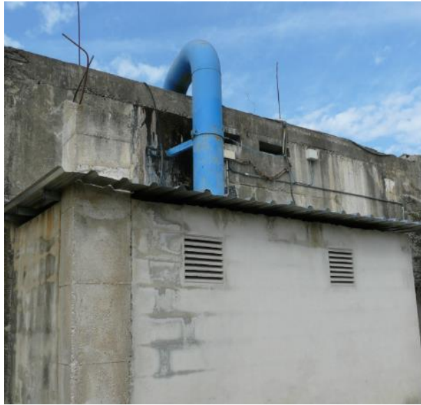
Figura 9: Vista tubería de llenado de la balsa Perdices (V=2700 m 3 )
