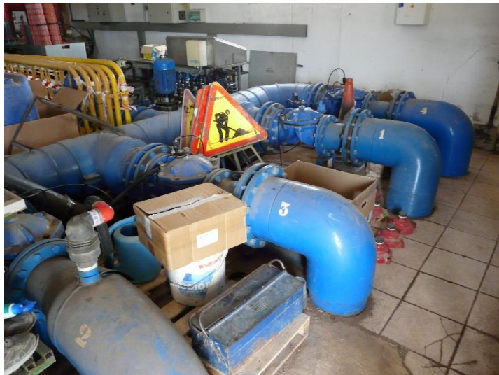
Figura 12: Ramificación redes secundarias a la salida del cabezal
