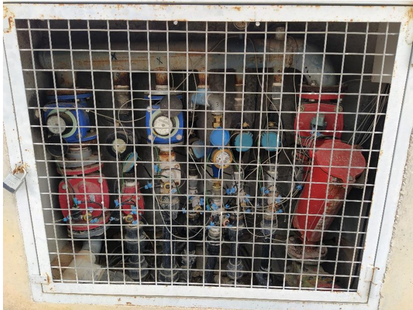
Figura 21: Detalle hidrante multiusuario, filtro caza piedras a la derecha en color rojo, y un total de seis tomas, cada una disponiendo de contador volumétrico y electroválvula
