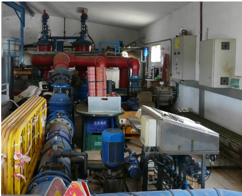
Figura 10: Interior del cabezal, en el fondo los equipos de filtrado de un color rojo, a la derecha el equipo de fertirrigación y en la parte baja la ramificación de la red para abastecimiento de los sectores
