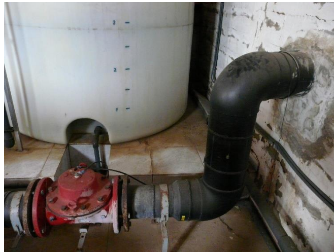
Figura 15: Tubería de entrada proveniente de la balsa Perdices y válvula de cierre
