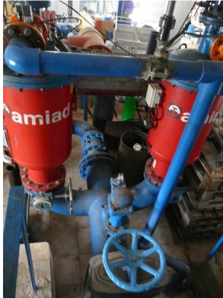
Figura 11: Equipo de filtrado cabezal, dos equipos de filtros de malla conectados en paralelo
