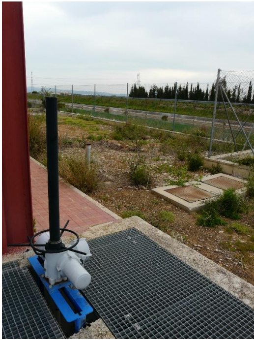
Figura 3: Compuertas entrada del agua del canal a la zona de aspiración
