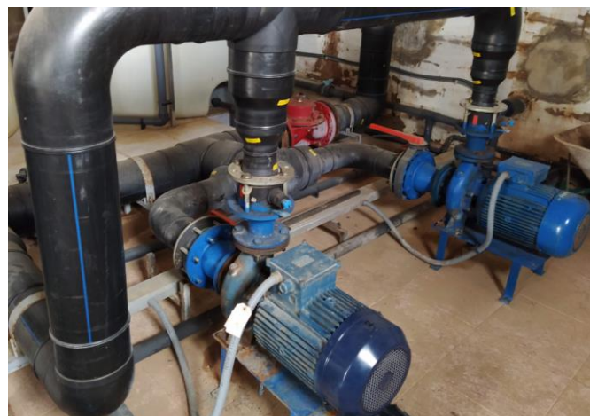
Figura 16: Electrobombas de accionamiento en el riego de la red 1.2
