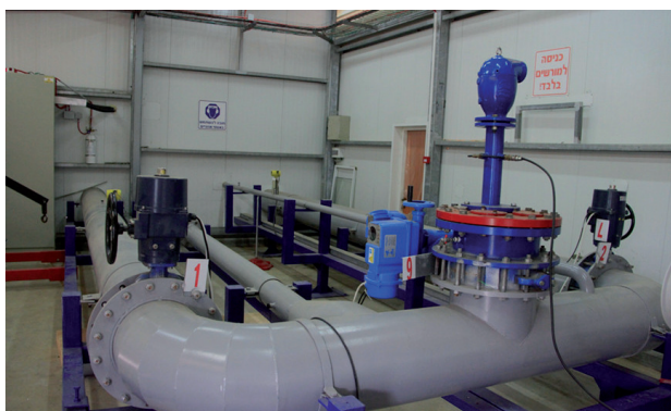
FIGURA 1. Vista general de la instalación de ensayos de la empresa Bermad en Nahariya (Israel).
