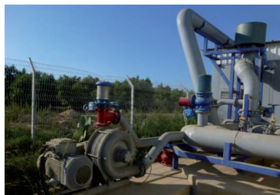
FIGURA 2. Soplante centrífuga del banco de ensayos de ventosas.
