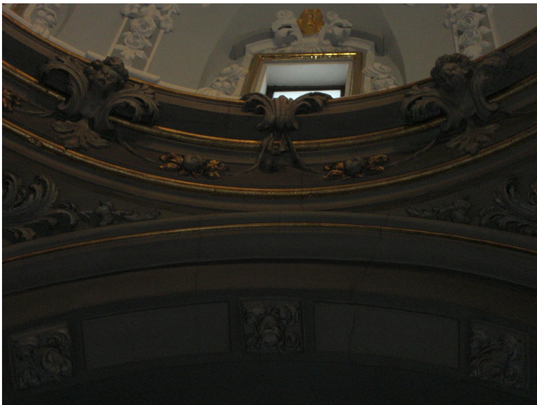
Foto 7. Arcos formeros agrietados en la clave.
