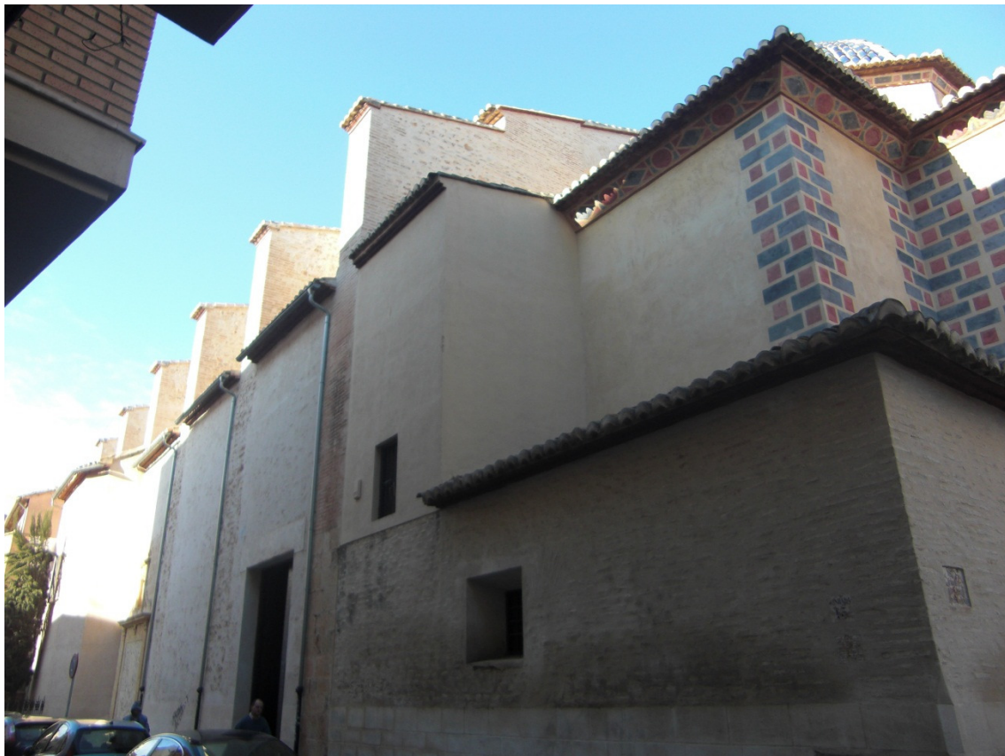
Foto 5. Fachada este con vista a los contrafuertes y humidades.
