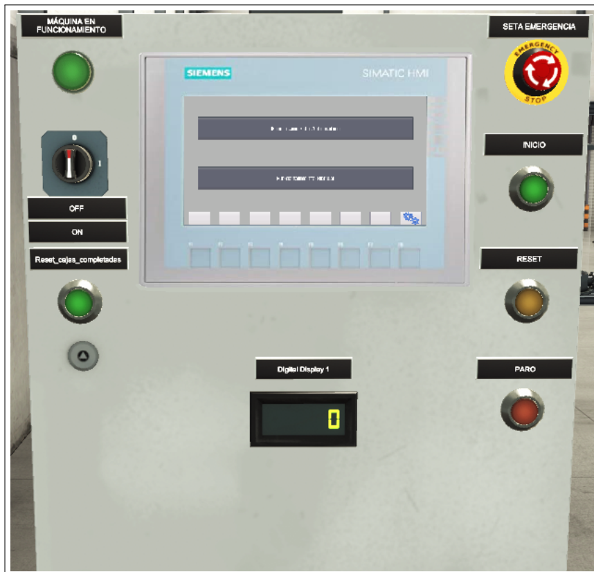
Figura 5.23: Vista del cuadro de mandos
