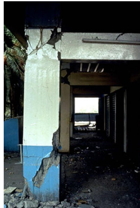
A la izquierda, diagrama que muestra la falta de cercos en la zona de rotura del pilar. A la derecha, Imagen del pilar de planta baja de un edificio de estructura de hormigón armado dañado durante el terremoto de Ciudad de México, México; Septiembre de 1985; magnitud Richter 8,1; máxima intensidad M.S.K. IX
