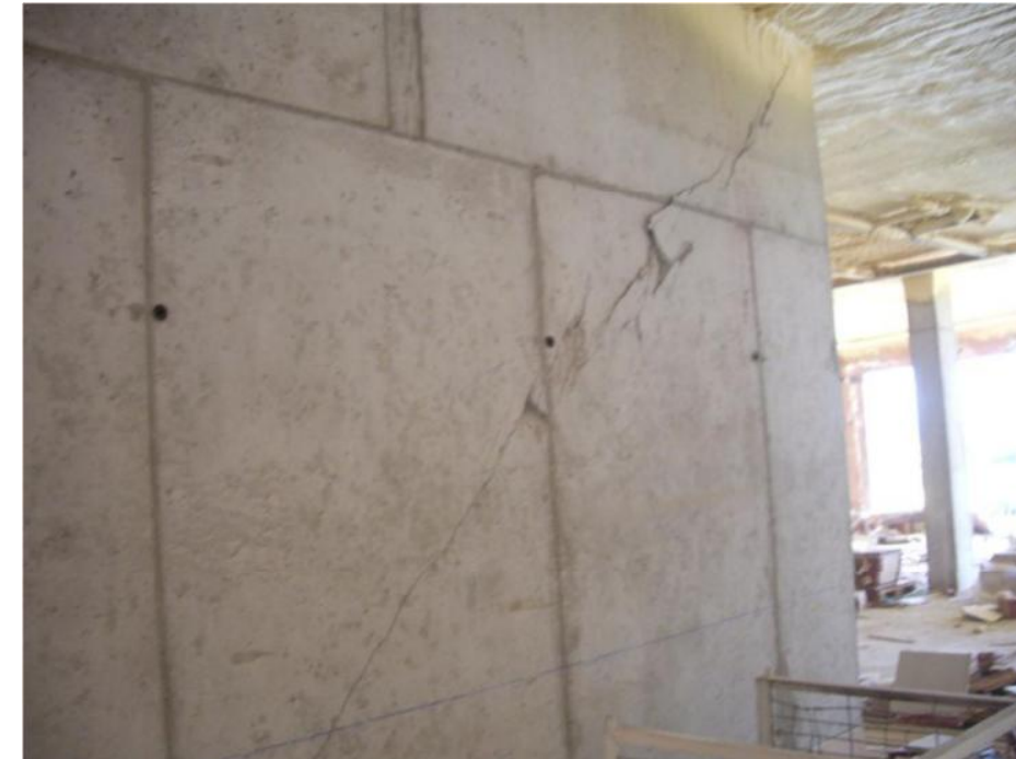
Daños en la pantalla de hormigón armado del ascensor, tras el terremoto de Lorca, España, mayo de 2011.
