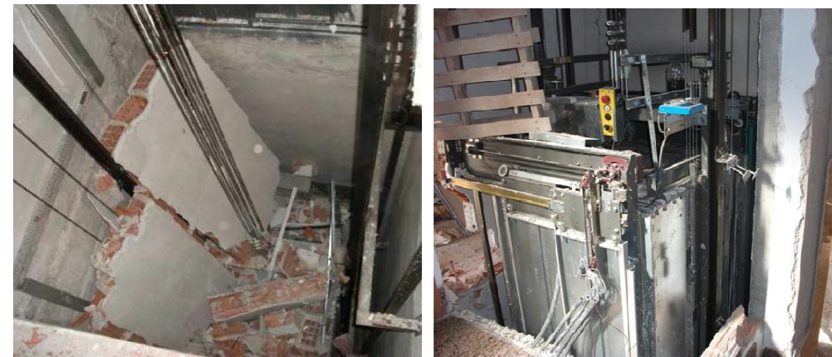
Vista de la cabina del ascensor y cerramientos derribados, tras el terremoto de Lorca, España, mayo de 2011.
