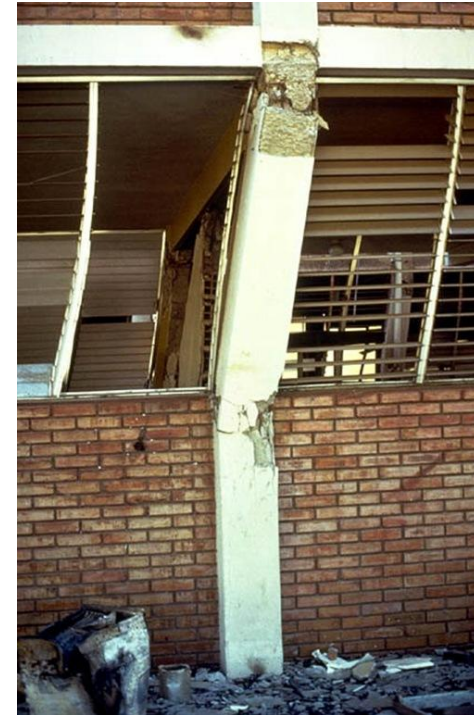
Edificio de estructura de hormigón armado y cerramiento y particiones de ladrillo, dañado durante el terremoto de Managua, Nicaragua en 1972, en el que se puede ver como el pilar no ha podido deformarse como en un principio había sido calculado por culpa del cerramiento que impedía el movimiento libre de la parte inferior del pilar.
