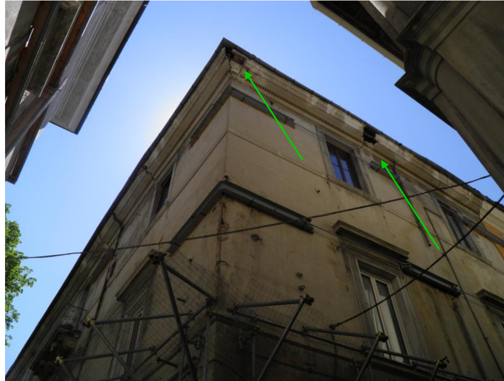
Edificio de estructura a base de muros de carga tras el terremoto de L'Aquila, Italia en 2009. En la imagen se observa que por temor a nuevas caídas de partes del zócalo decorativo, se instaló una red anclada al muro que recogería estos elementos en caso de caída.
