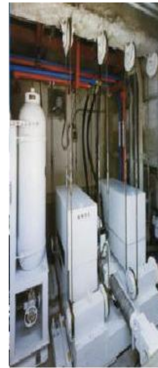
Imagen de los dos osciladores AMD instalados en la azotea del edificio Kyobashi Seiwa, en Japón
