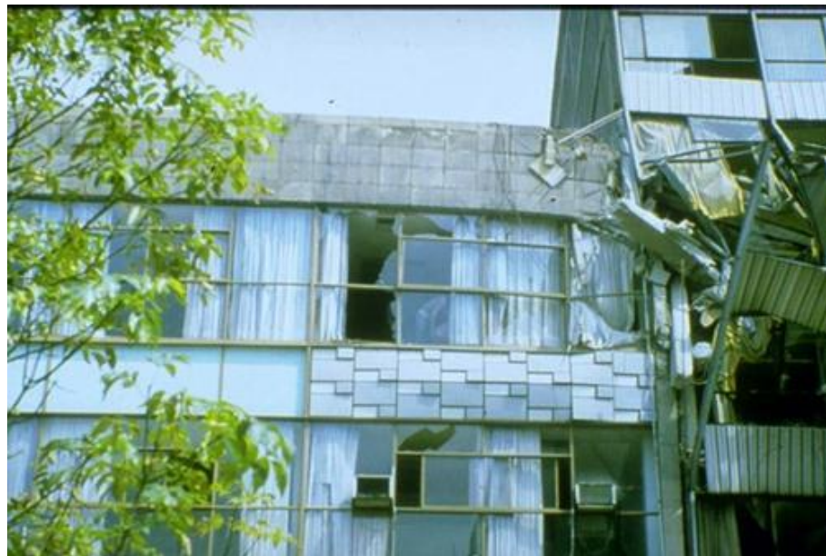
Imagen del Hotel Carlo frente al Monumento a la Revolución (Ciudad de México, México). Se trata de un edificio de estructura de hormigón armado y fachada formada por un muro cortina, dañado durante el terremoto de Septiembre de 1985; magnitud Richter 8,1; máxima intensidad M.S.K. IX. En las imágenes observan graves daños estructurales con colapso de una planta intermedia.
