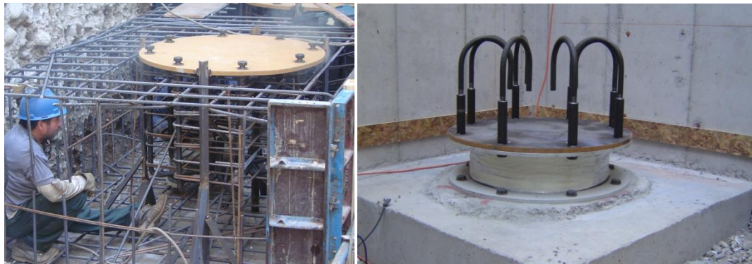
A la izquierda, placa de anclaje a la cimentación del aislador. A la derecha, aislador ya colocado con esperas para anclarse a la estructura. Edificio de Consultas ACHS Santiago, Chile Edificio de 7 pisos y 3 subterráneos. Estructura mixta de muros (núcleo) y marcos de hormigón armado (5.330 m2).
