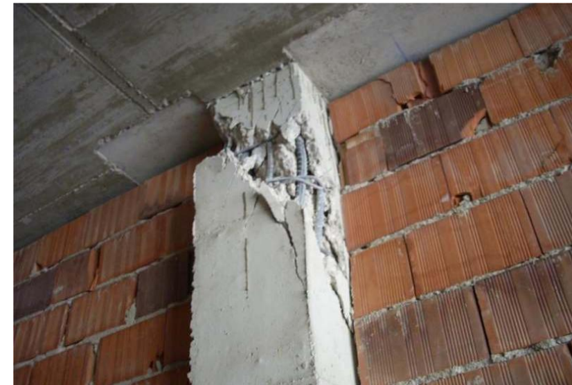
Imagen del pilar de planta baja de un edificio de estructura de hormigón armado después del terremoto Lorca, España; Mayo de 2011.
