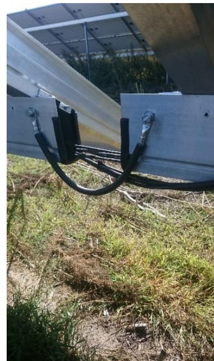
Figura 40 - "Conexión entre seguidores"
