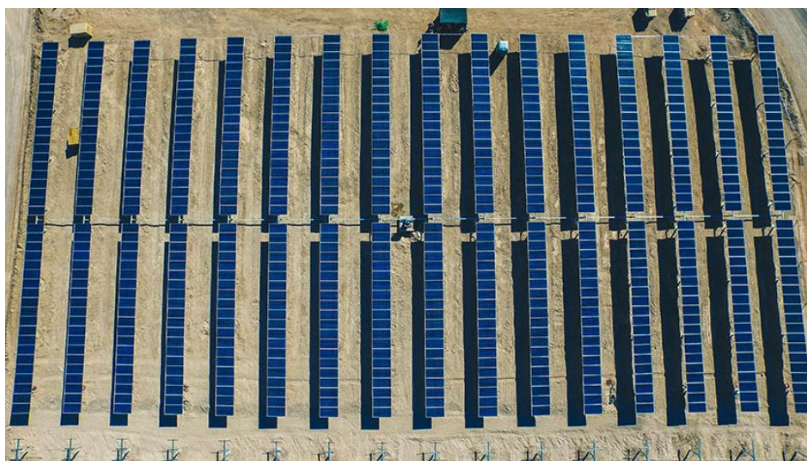
Figura 18: Paneles sobre estructura de seguidor solar STI-H1250 (Fuente: stinordland.com)
