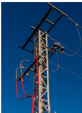
Figura 36: Detalle de apoyo con seccionador y pararrayos (Fuente: Google imágenes)
