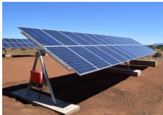
Ilustración 2: Paneles solares en estructura móvil de 1 eje (Fuente: degeriberica.com)
