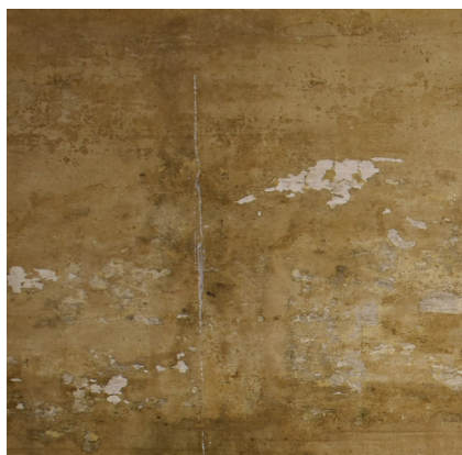
Fig. 23. Marcas causadas por el enrollamiento
