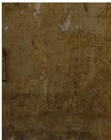
Fig. 25. Manchas de humedad.
