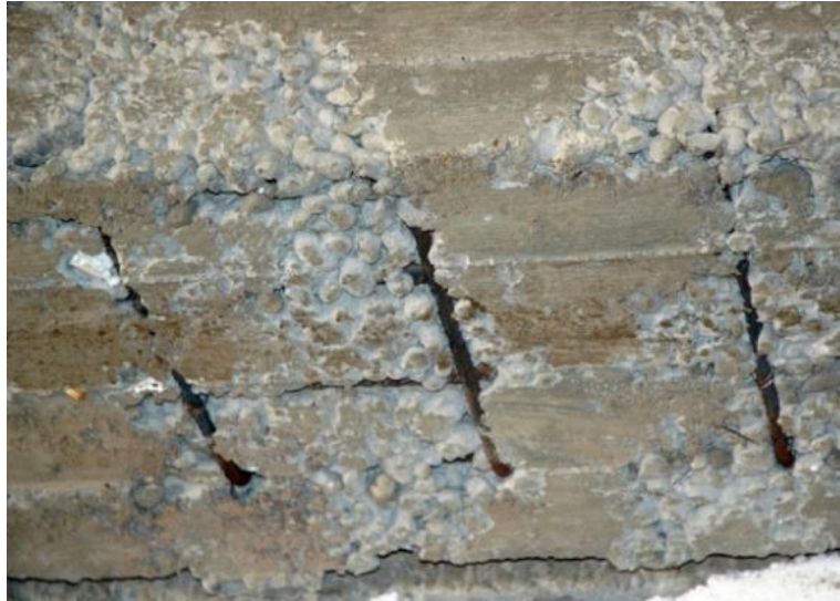
Figura 2.2 Fenómeno de segregación en hormigón ya endurecido. Fuente: [4]
