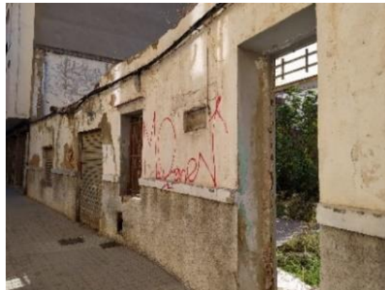
Ilustración 14. Vivienda en estado ruinoso. Fuente: propia.
