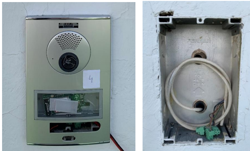
Figura 79. Placa con caja de empotrar metálica en la pared
