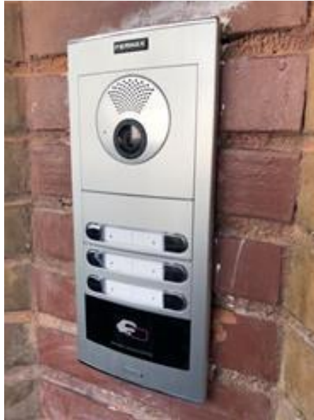
Figura 134. Placa de la instalación piloto 02
