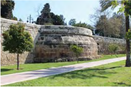
Alteraciones en la continuidad.
