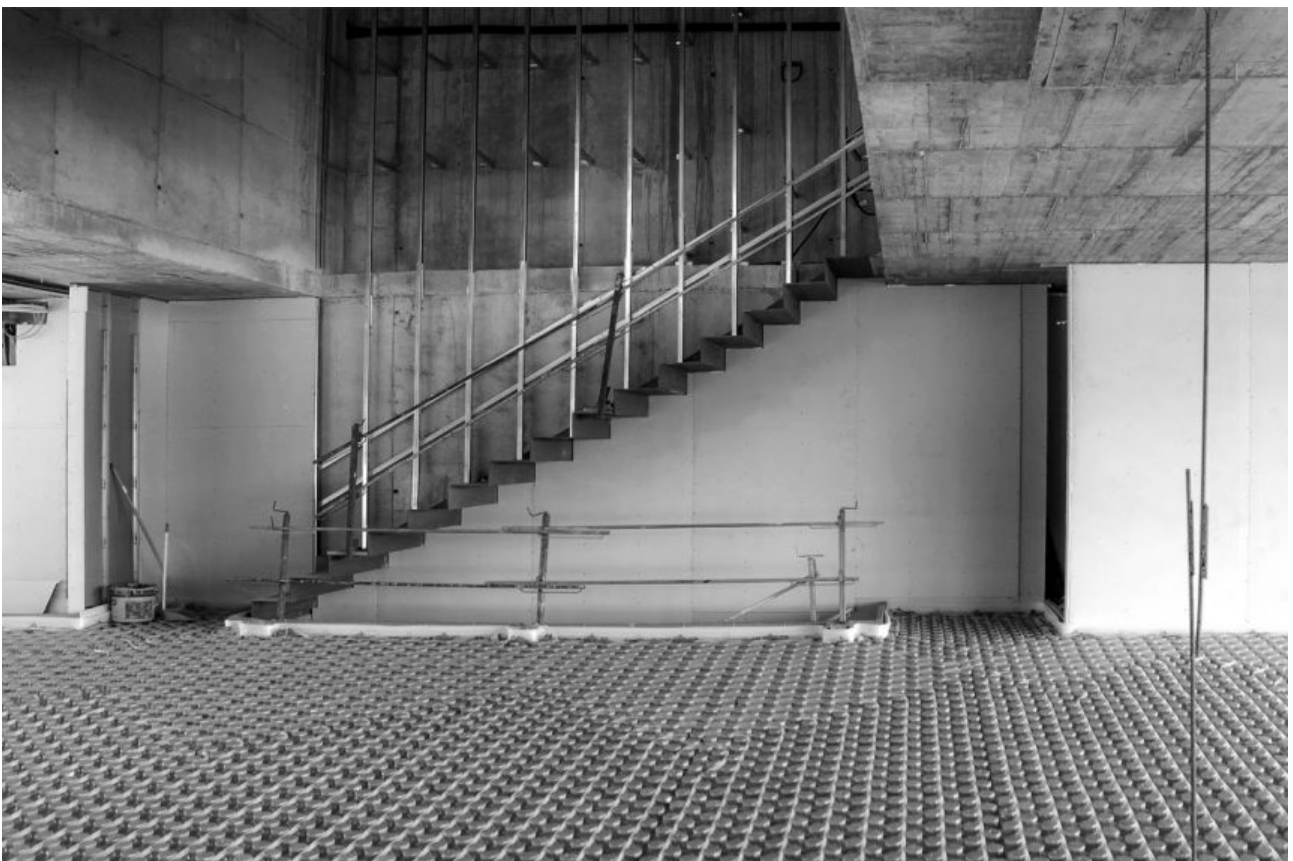
Figura 3.2.-6. Fotos obra Casa Balint. Escalera principal. Fuente: Fran Silvestre Arquitectos
