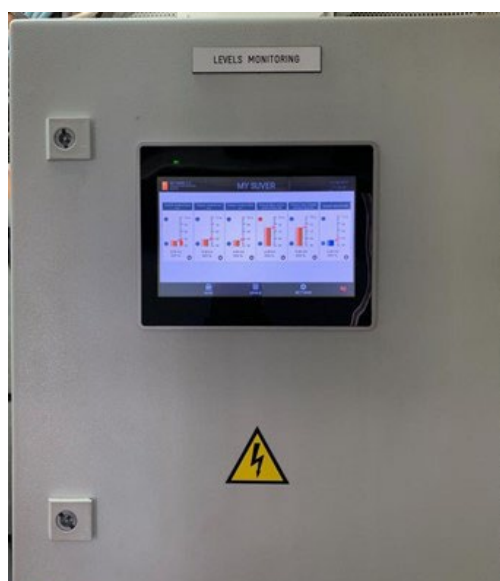
Figura 18: Instalación de la interfaz HMI en el cuadro de tensión del barco al exterior de la cámara de máquinas
