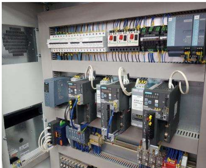
Figura 2.7 Instalación actual de un sistema automatizado
