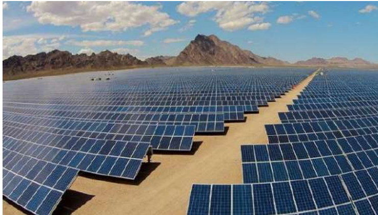
Ilustración 2: Parque solar fotovoltaico para suministro de energía eléctrica.
