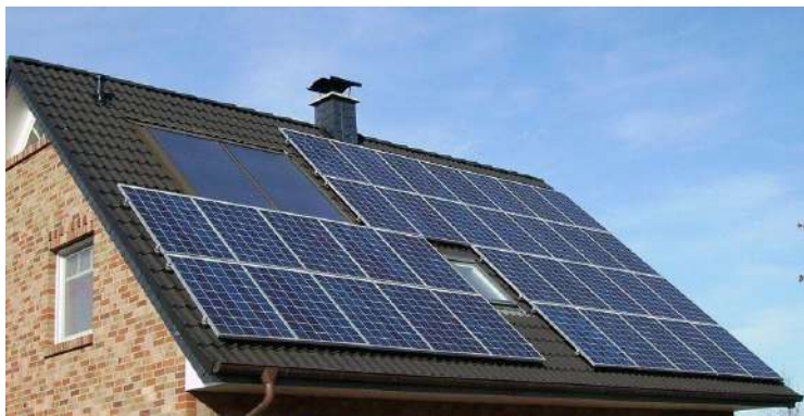
Ilustración 3: Instalación solar fotovoltaica sobre tejado para autoconsumo.
