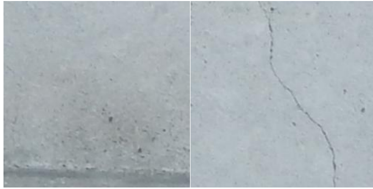
Figura 7. Imágenes No fisurado/fisurado - SDNET2018 (Muros de hormigón).
