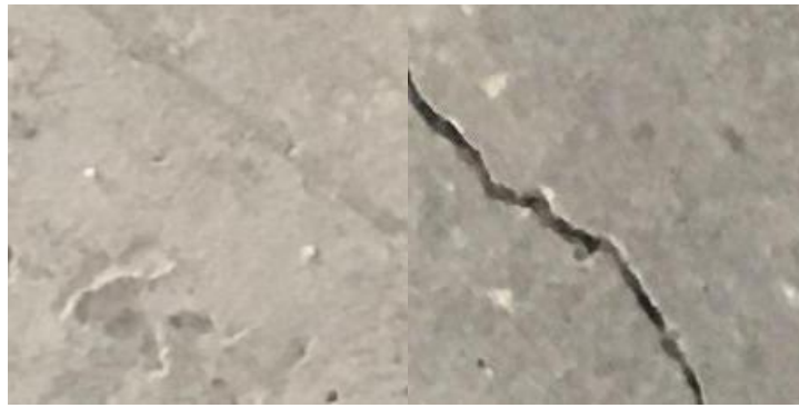
Figura 8. Imágenes No fisurado/fisurado - METU
