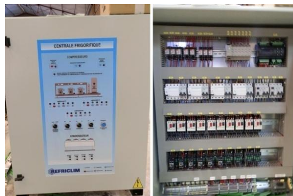
Ilustración 107. Ejemplos de cuadros eléctricos.
