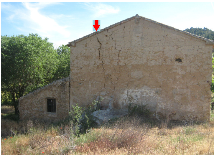
Grieta importante en la fachada oeste
