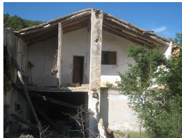
Muro de carga derruido en la fachada este
