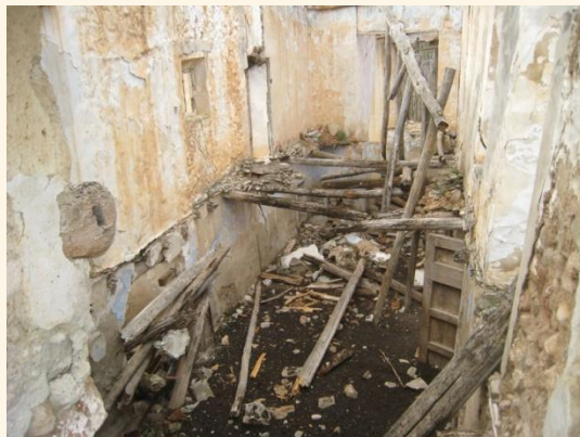
Forjado en ruinas (Molino de Mateo)
