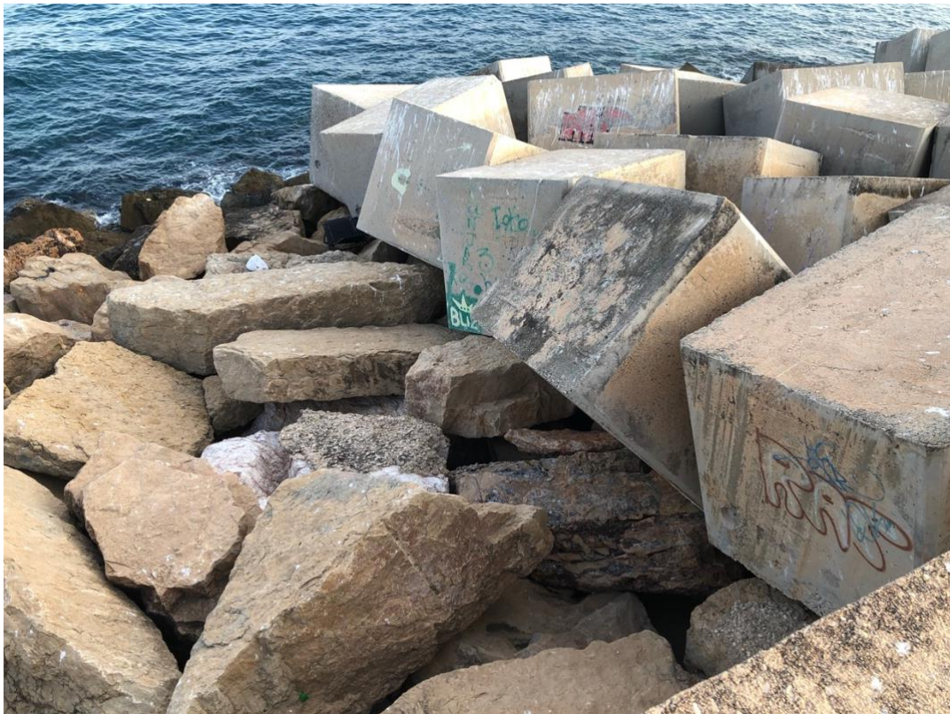
Imagen 8. Detalle del inicio del tramo 3 del dique. Manto de bloques de hormigón sobre escollera.
