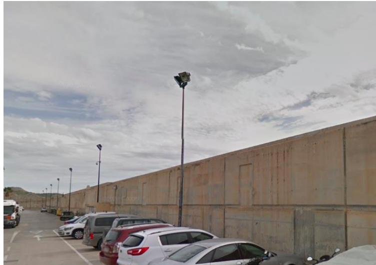
Imagen 2. Espaldón actual en el dique de Levante del puerto de Villajoyosa (Fuente: Google Maps)
