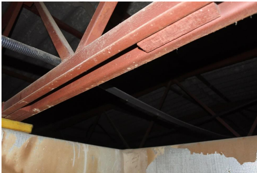
Ilustración 92. Conducto de calefacción, falso techo del edificio, Fuente: (Elaboración Propia)
