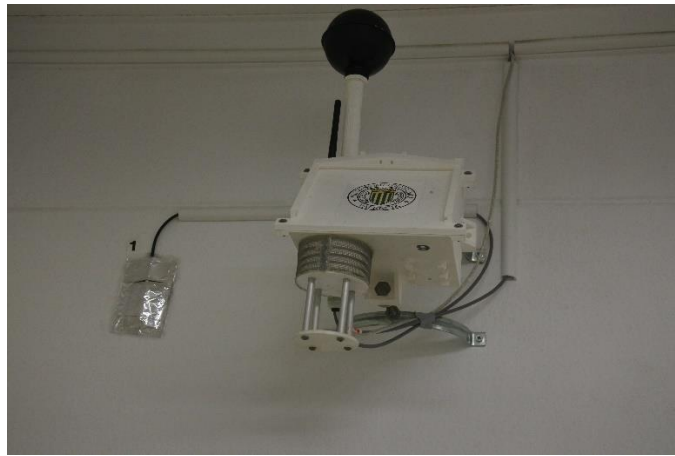
Ilustración 76. Sensor Interior, situado dentro del aula "P1 aula 1", Fuente: (Elaboración Propia)
