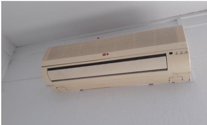
Ilustración 49. Equipo Climatización Split, Fuente: (Elaboración Propia)
