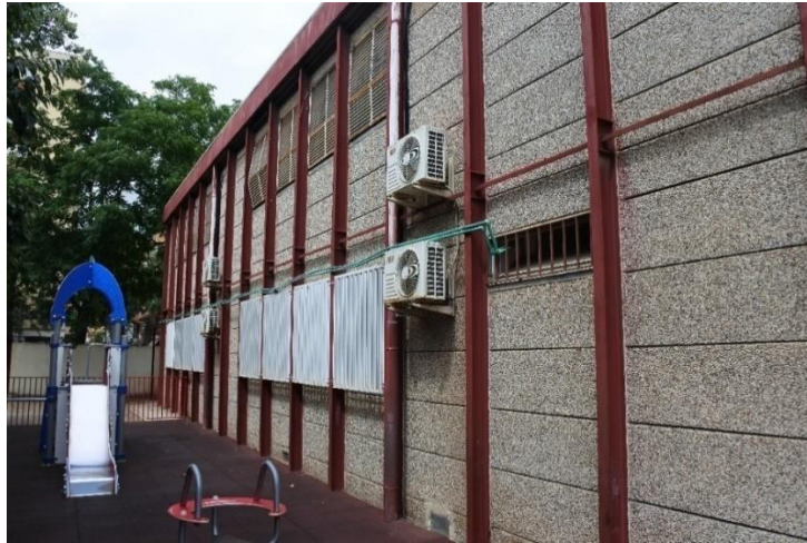
Ilustración 51. Condensadores Equipos Climatización, Fuente: (Elaboración Propia)
