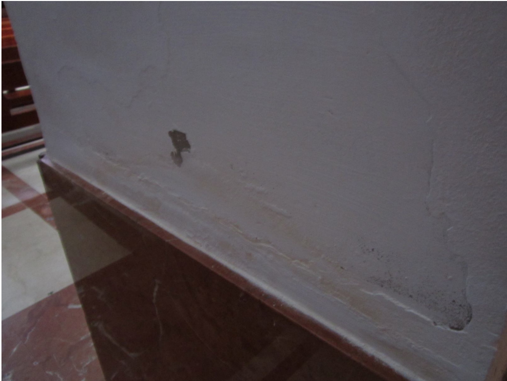
Fotografía muestra de la ascensión de la humedad por encima del zócalo.(interior del templo)
