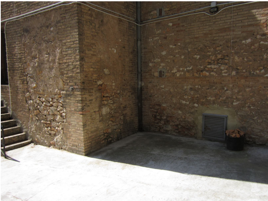
Muestra de que el problema de la humedad sigue patente en el muro( fotografía del muro en la parte recayente al patio interior )
