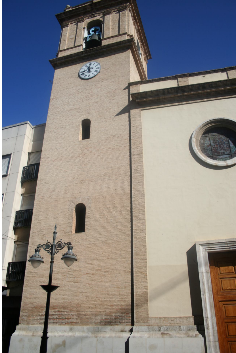
Fotografía muestra de la ascensión de la humedad por encima del zócalo.
