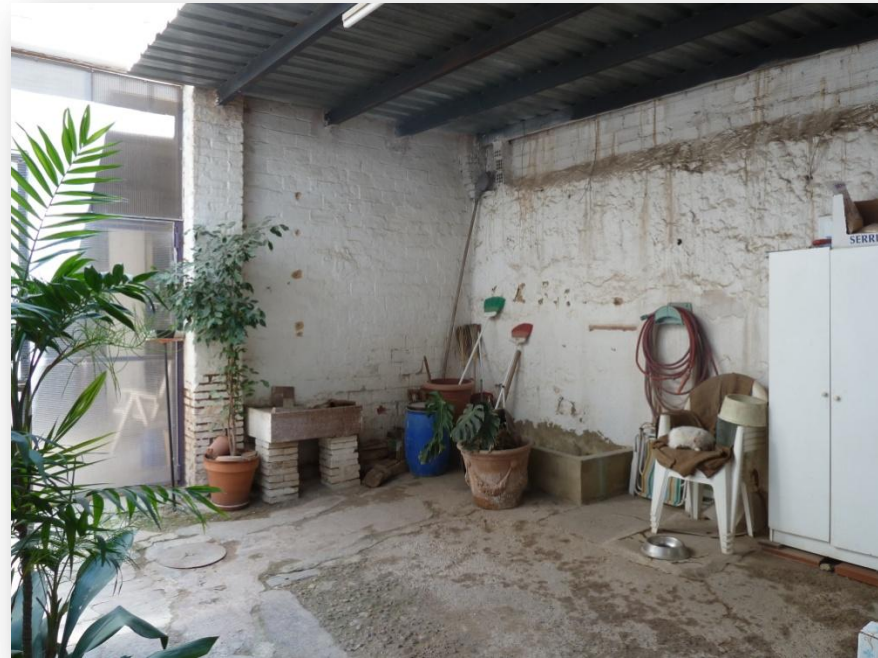
Patio interior de Planta Baja. A la derecha de la imagen quedan situados el aljibe y el comú.
