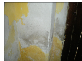
Detalle Desconchado de pintura (HCDS)
