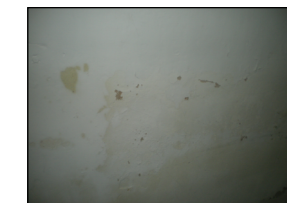
Detalle manchas de moho (HIM)
