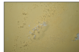
Detalle Eflorescencia (HCDSE)
