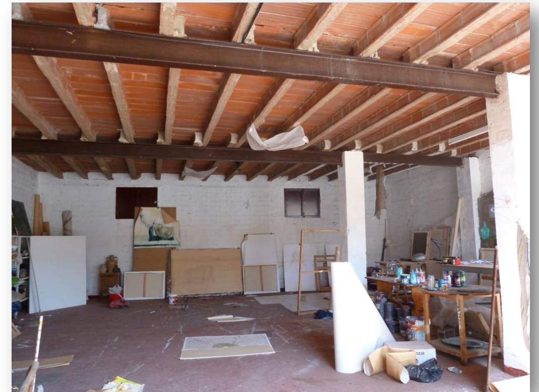
Interior de la Planta Primera del Cobertizo, de distribución diáfana y estructura de pilar de fábrica de ladrillo cerámico, vigas metálicas y viguetas de violín.
