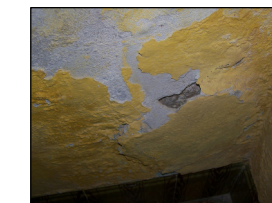
Detalle Desprendimiento de pintura (HIDPC)
