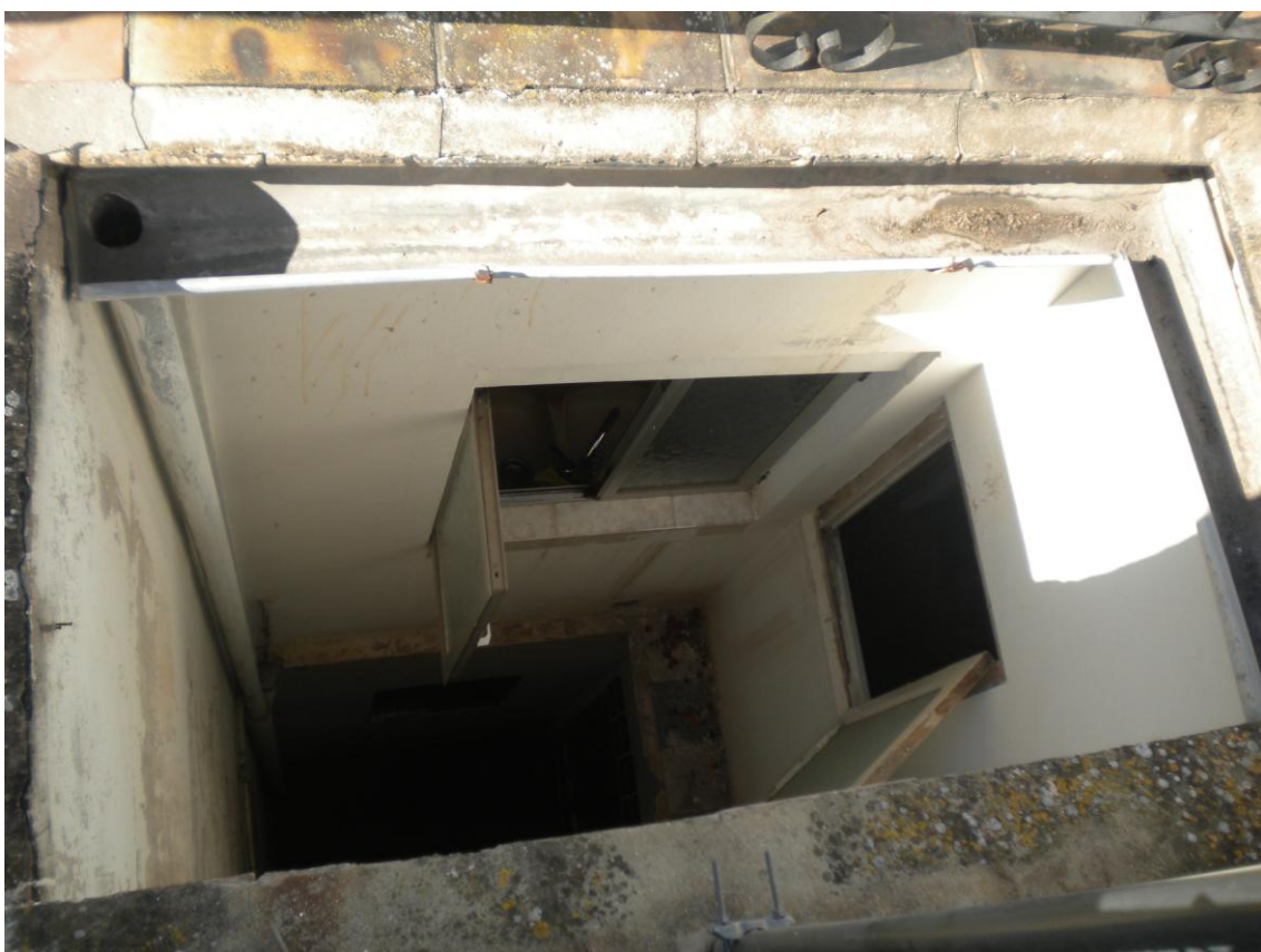
Canaló a dues de les parets que s'observen lliures d'humitats.
