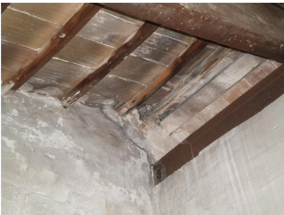
Humitats i ennegriment a la part superior del mur capcer sud.
