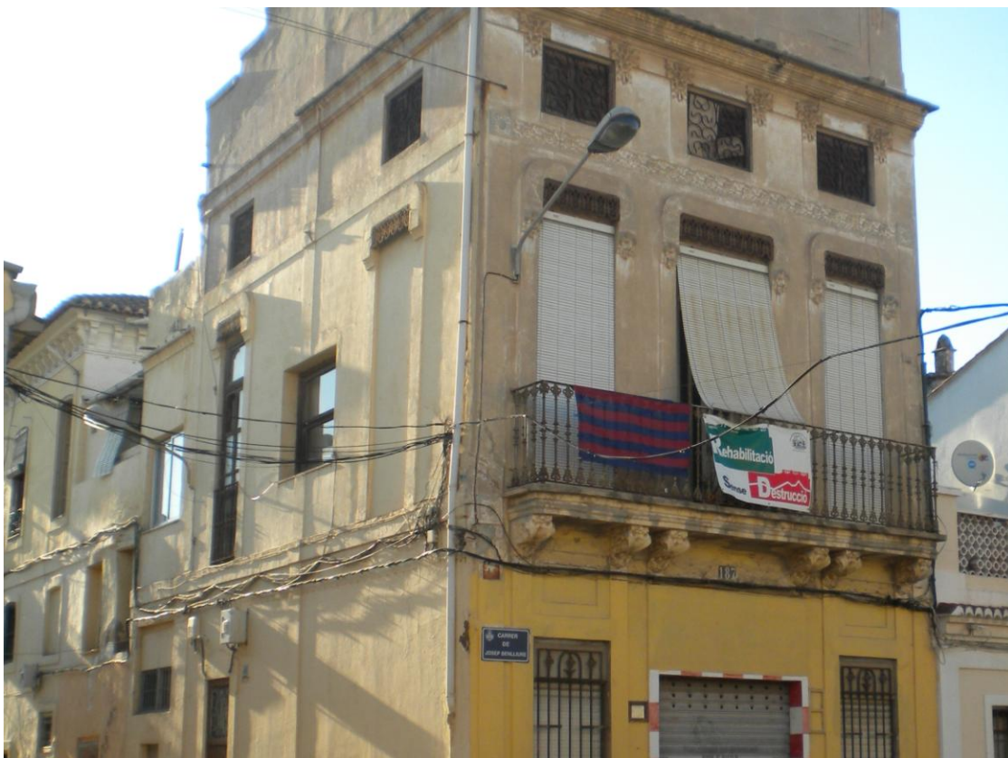
Visió del desordre, faroles, i la quantitat de cables a ambdues façanes i que arriben a aquestes.
