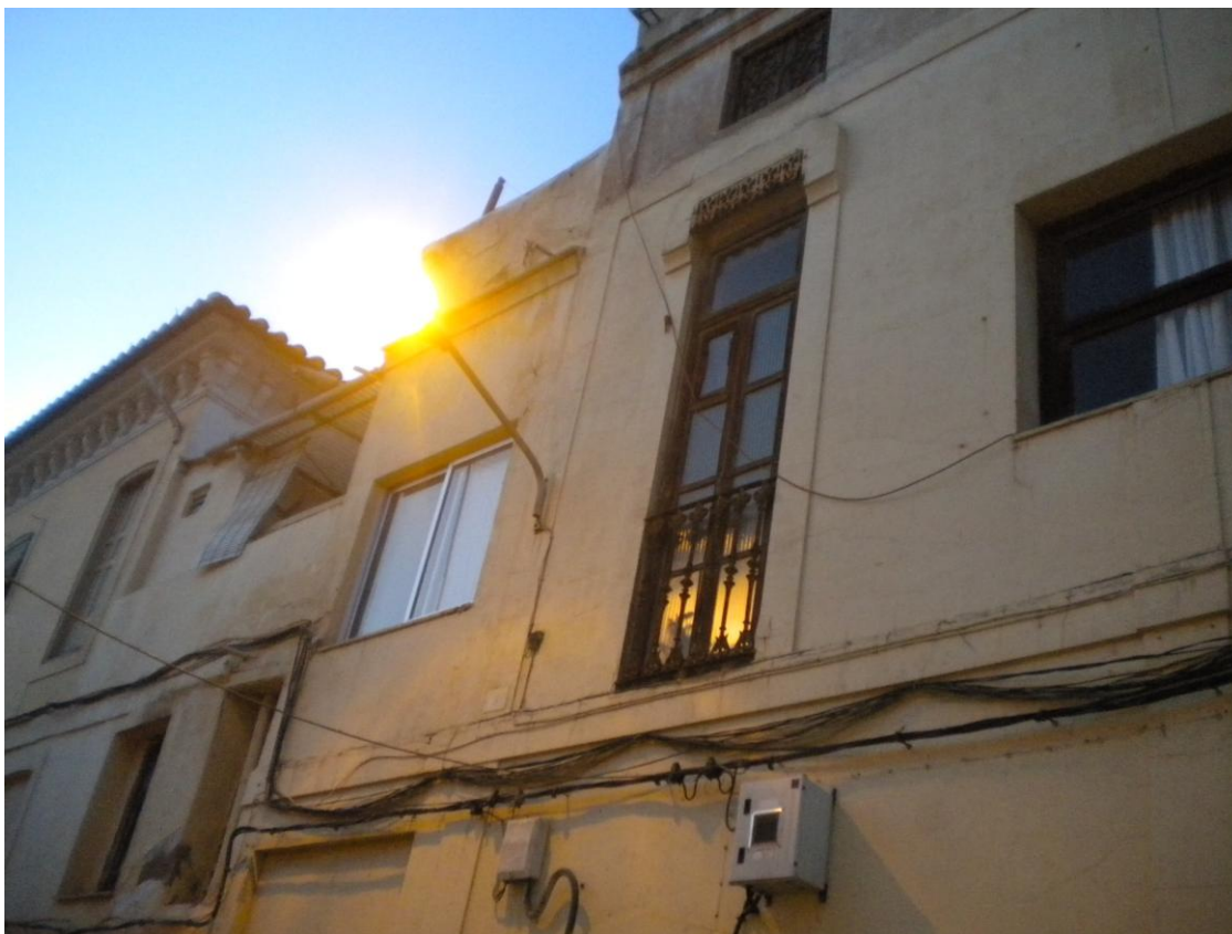
Cables, faròla il·luminada i caixes de registre a la façana sud.
