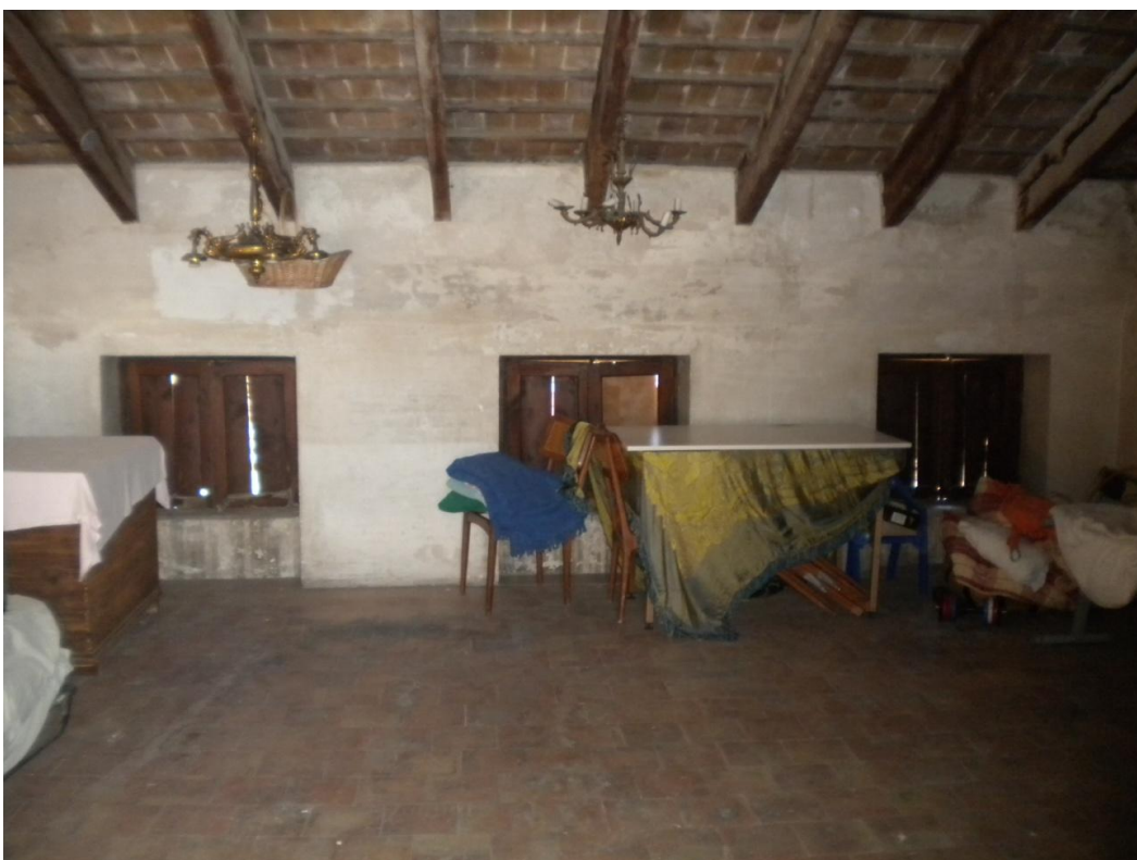
Cara interior dels buits de la façana principal – escamesa dels cavalls al mur est.
