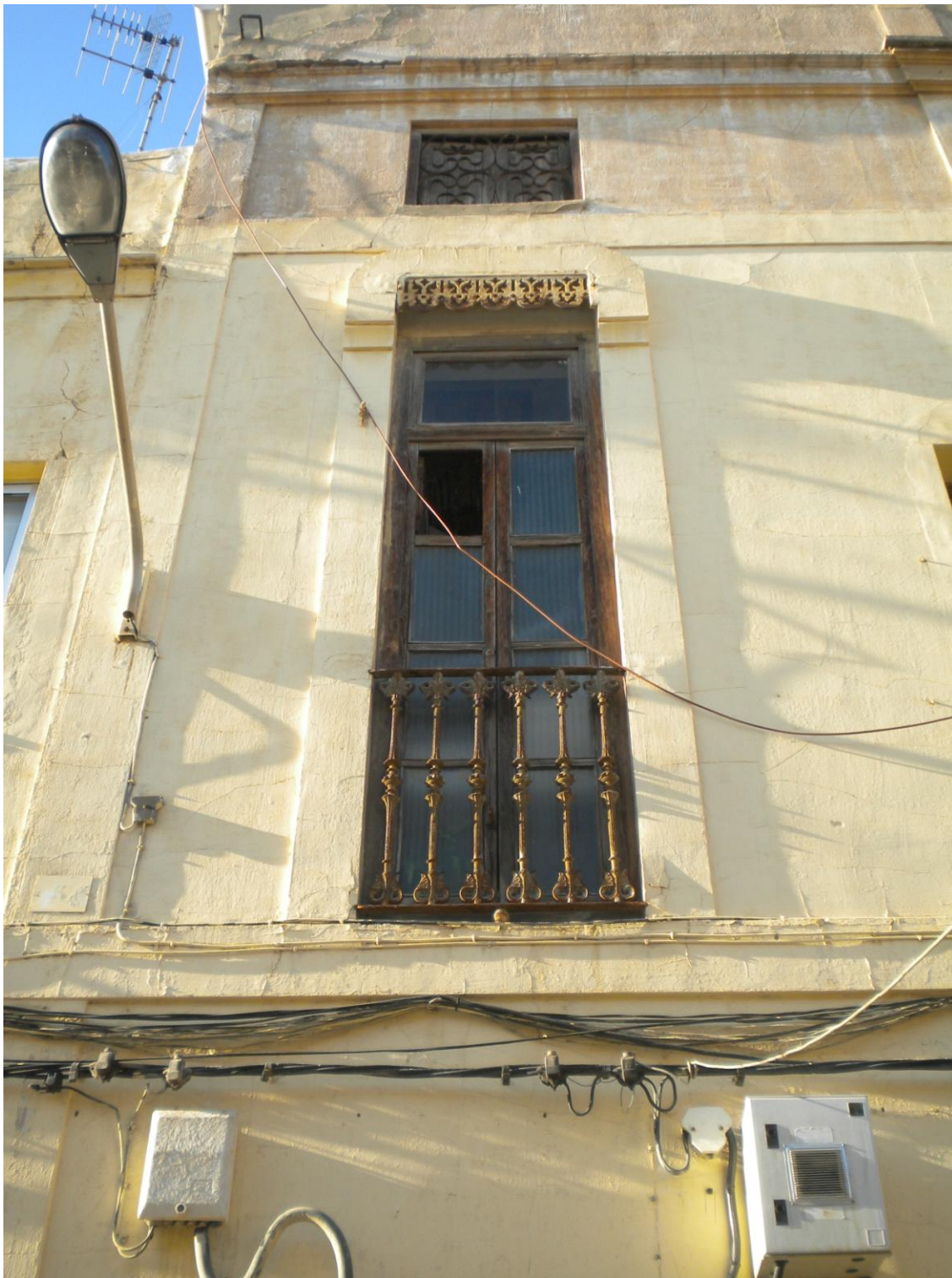
Cables, caixes i farola a la façana sud.
