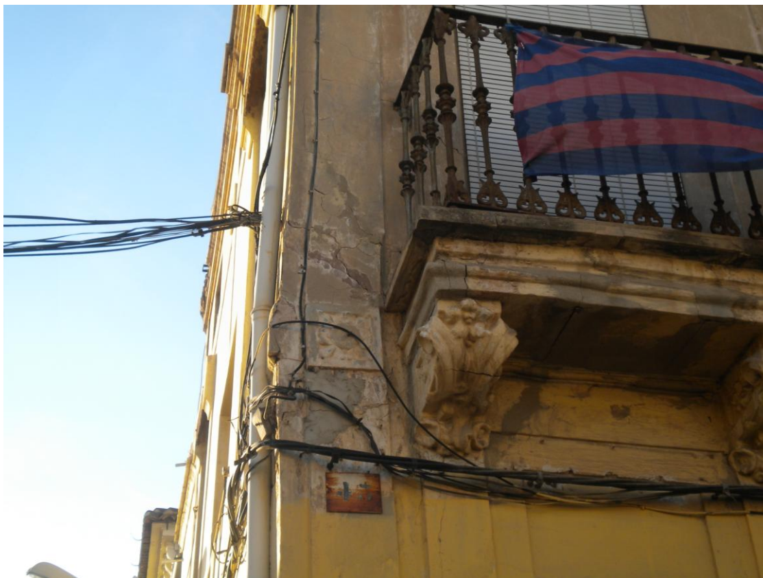
Cables a la façana principal, i cables que arriben a aquesta.
