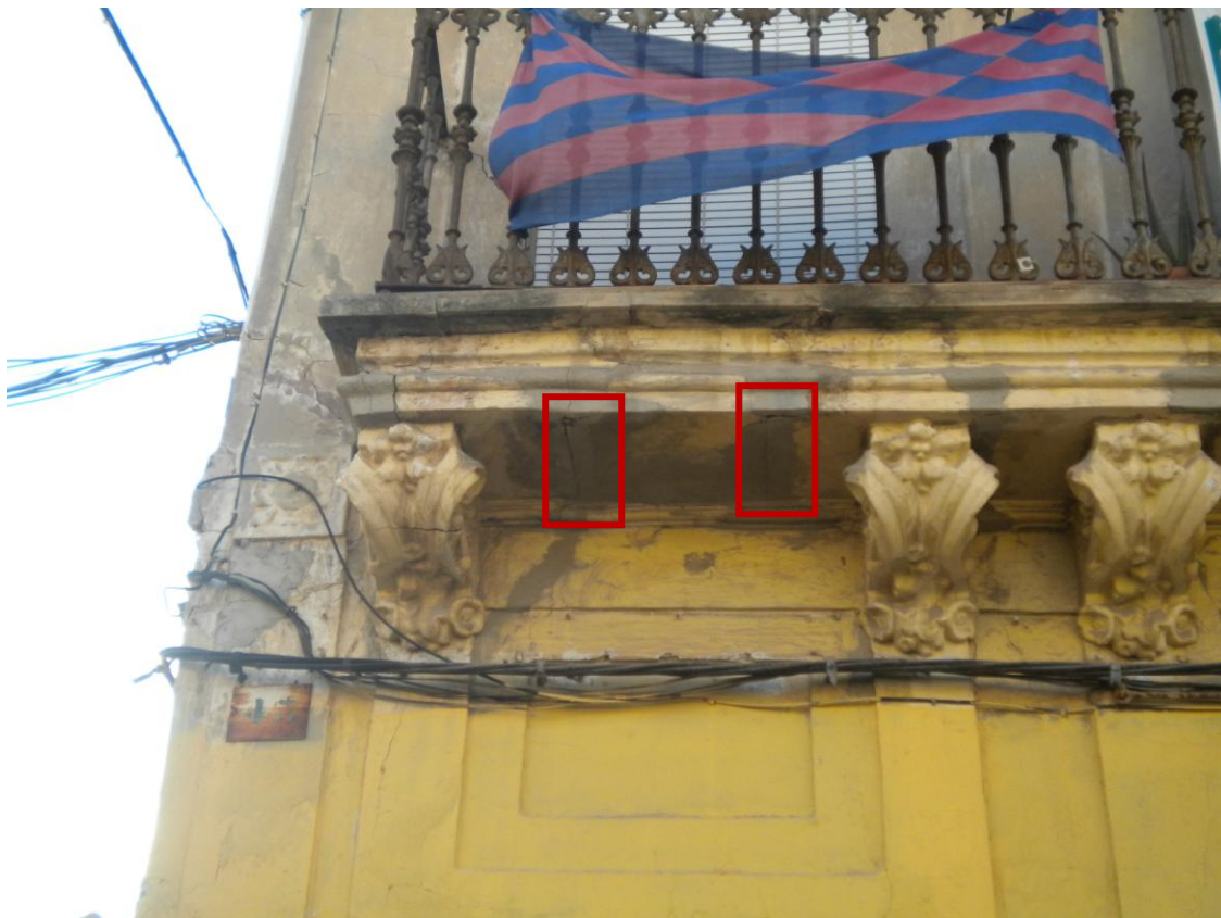
Esquerdas a la part esquerra del balcó on s'observen un poc millor les armadures prominents.
