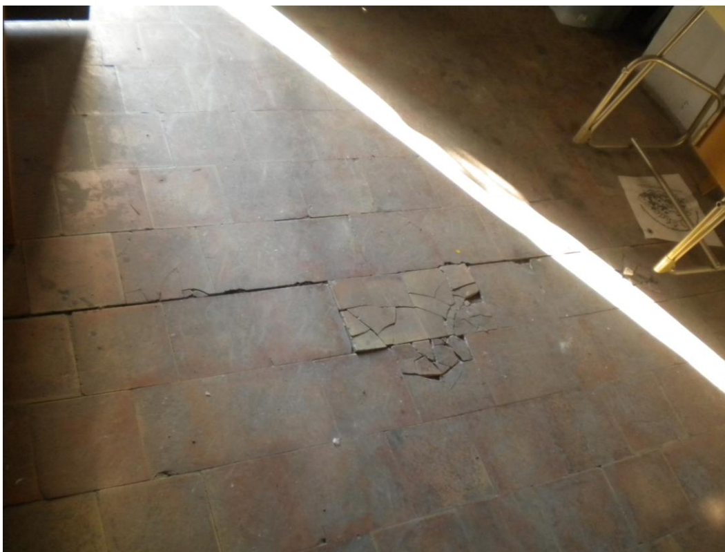
Separació del paviment en el traçat de l'esquerda a la cambra (sòl de segona planta).
