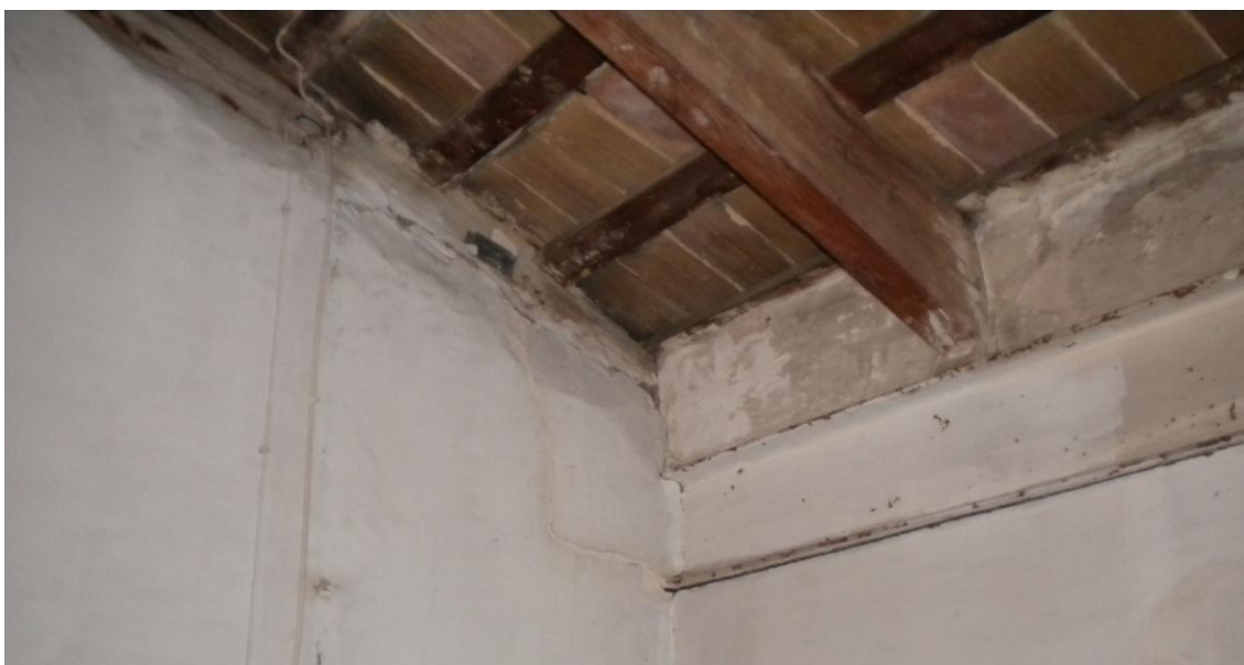
Humitats a la part superior del cantó sud-oest de la cambra.
