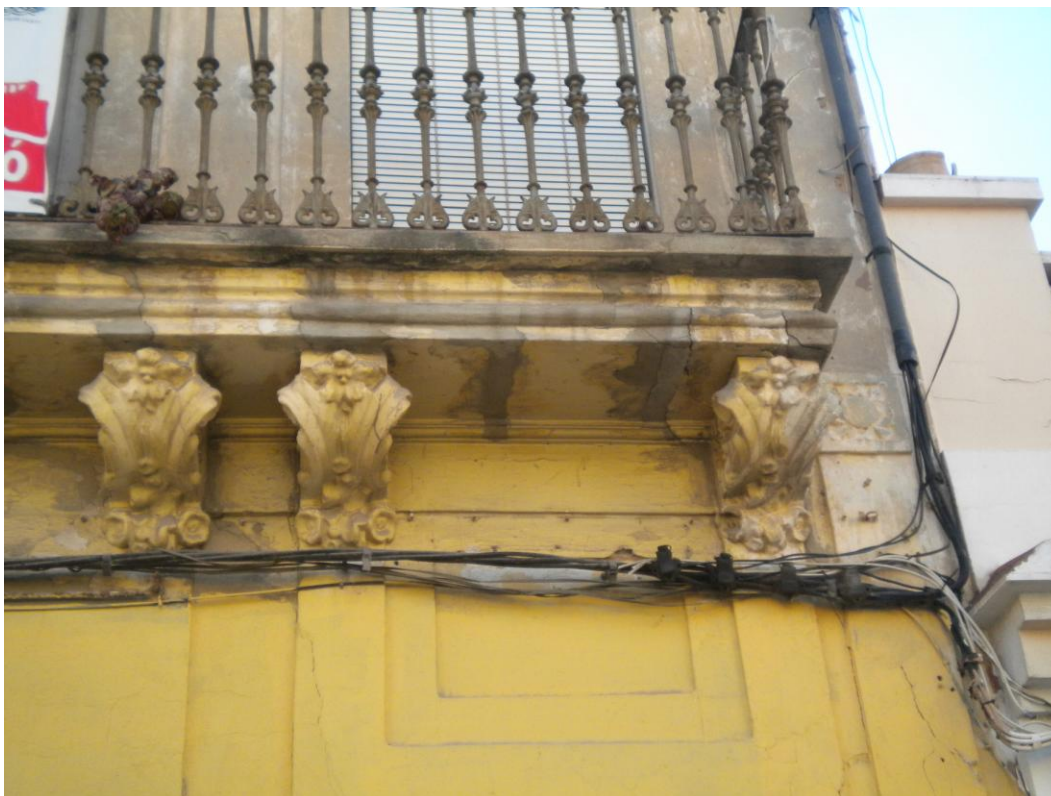
Gran quantitat de cables a la façana principal (est).
