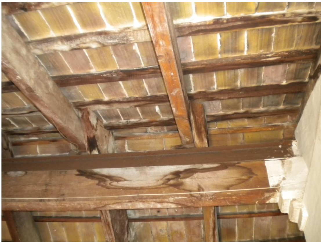
Taques per humitat als elements estructurals de coberta, zona del carener.
