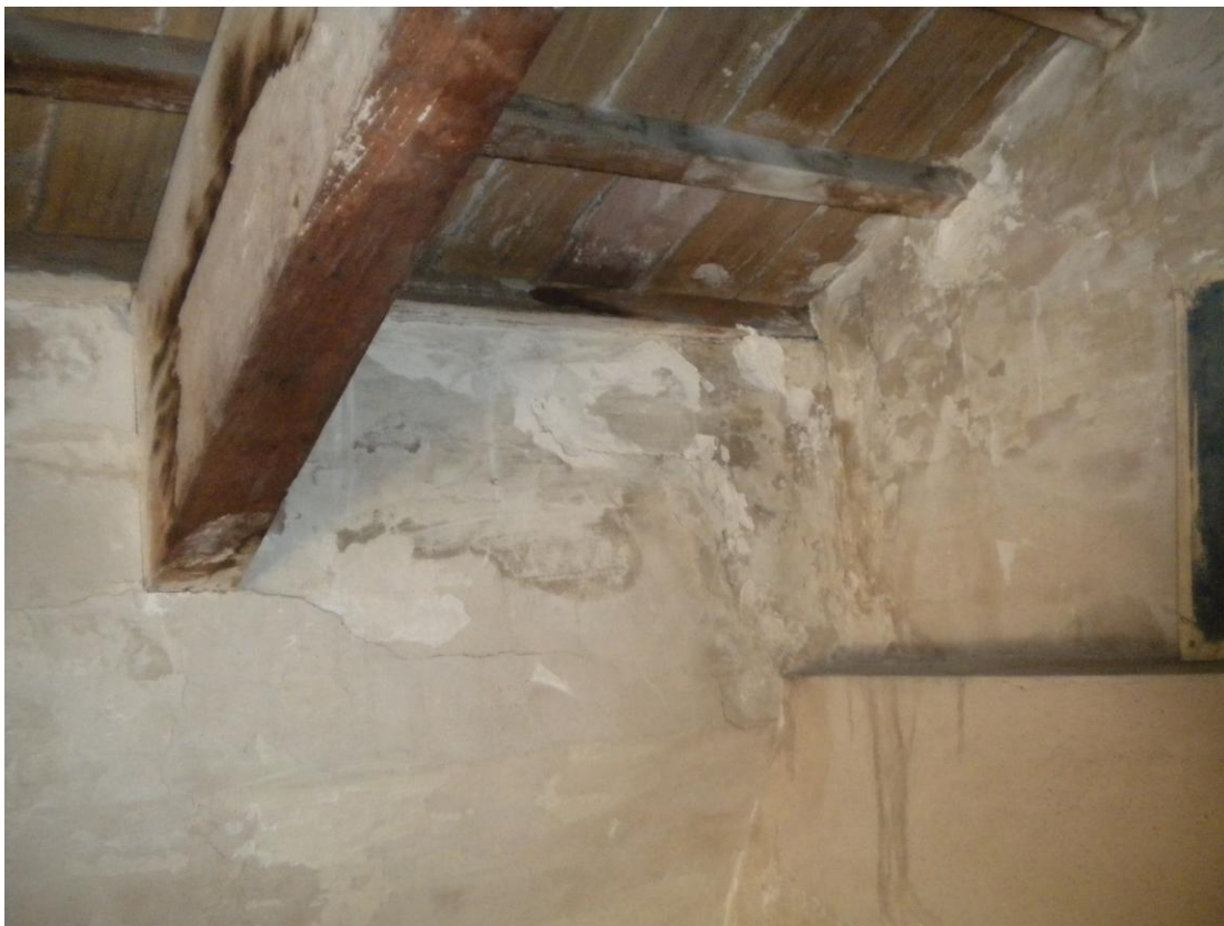
Humitats a la part superior del cantó dels murs est i sud.
