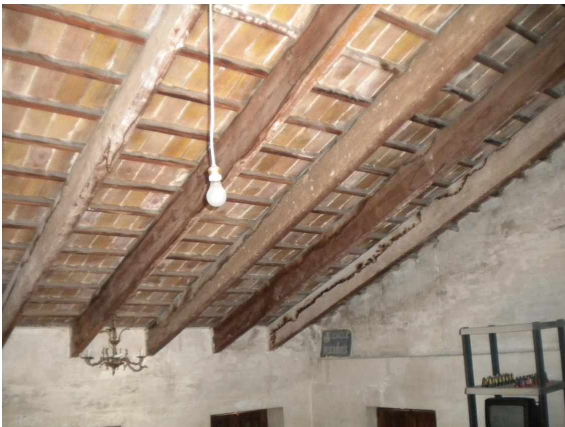
Humitats a la part superior dels murs sud i est.
