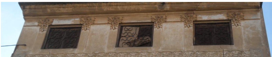
Reixes de ferro de forja als buits quadrats de planta segona en la façana principal.
