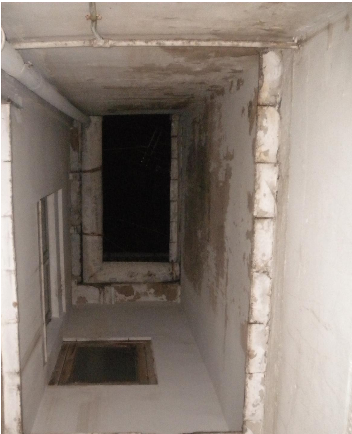
Imatge on s'aprecien les dues parets amb humitats i les dues amb canaló sense humitats.
