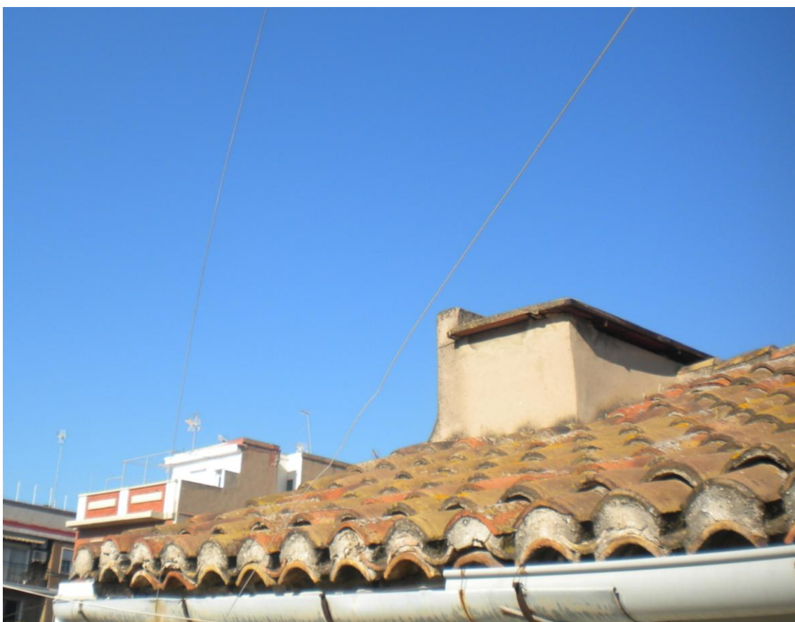
Imatge on s'observa l'element sobreeixint per coberta i adossat al mur nord. Es pot apreciar com la part d'aquest mur es prolonga lleugerament sobre el cos prismàtic i actua de guia.
