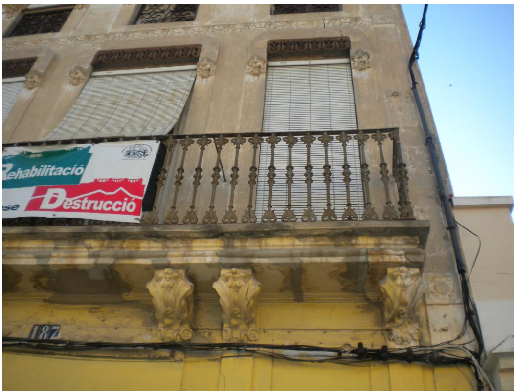
Gran quantitat de cables a la façana principal (est).
