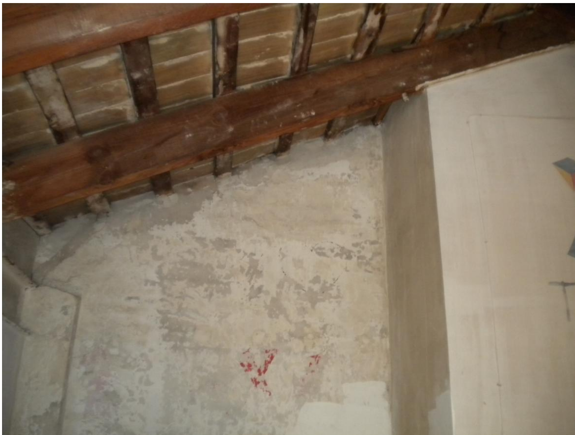
Humitats a la part superior del mur nord.
