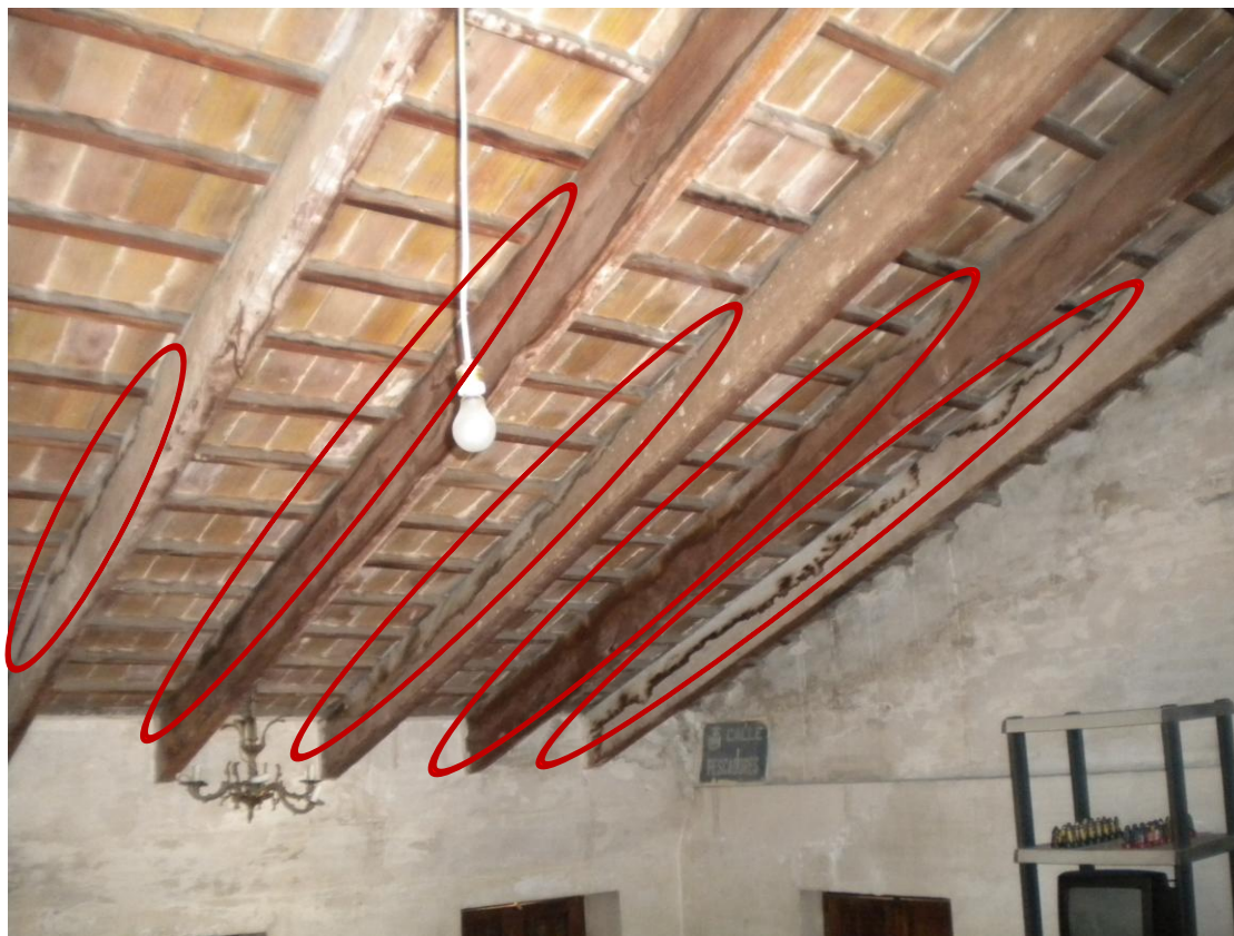
Taques per humitat als elements estructurals de coberta.
