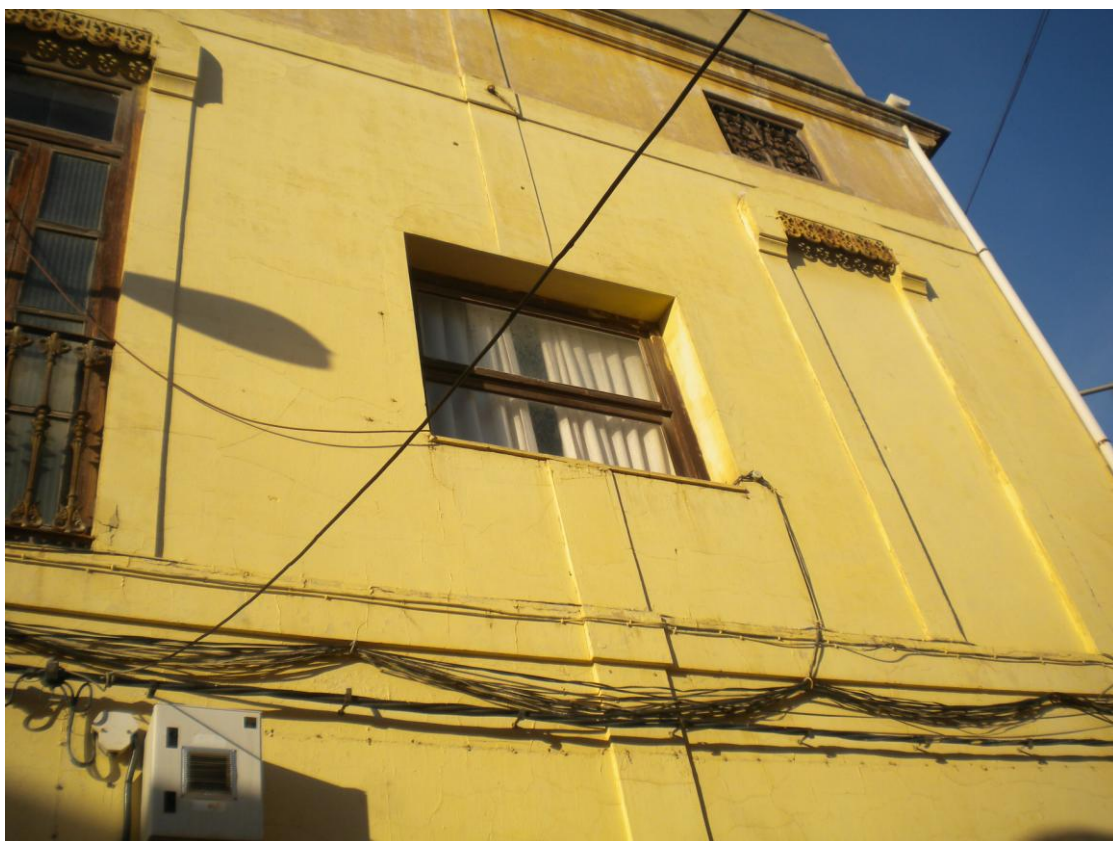
Quantitat de cables i caixa a la façana sud, cables que arriben a questa, cables desordenats.
