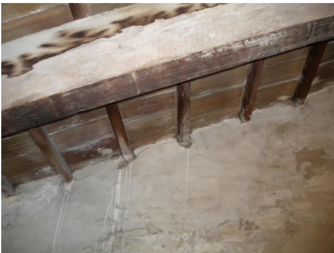
Humitats a la part superior del mur sud.
