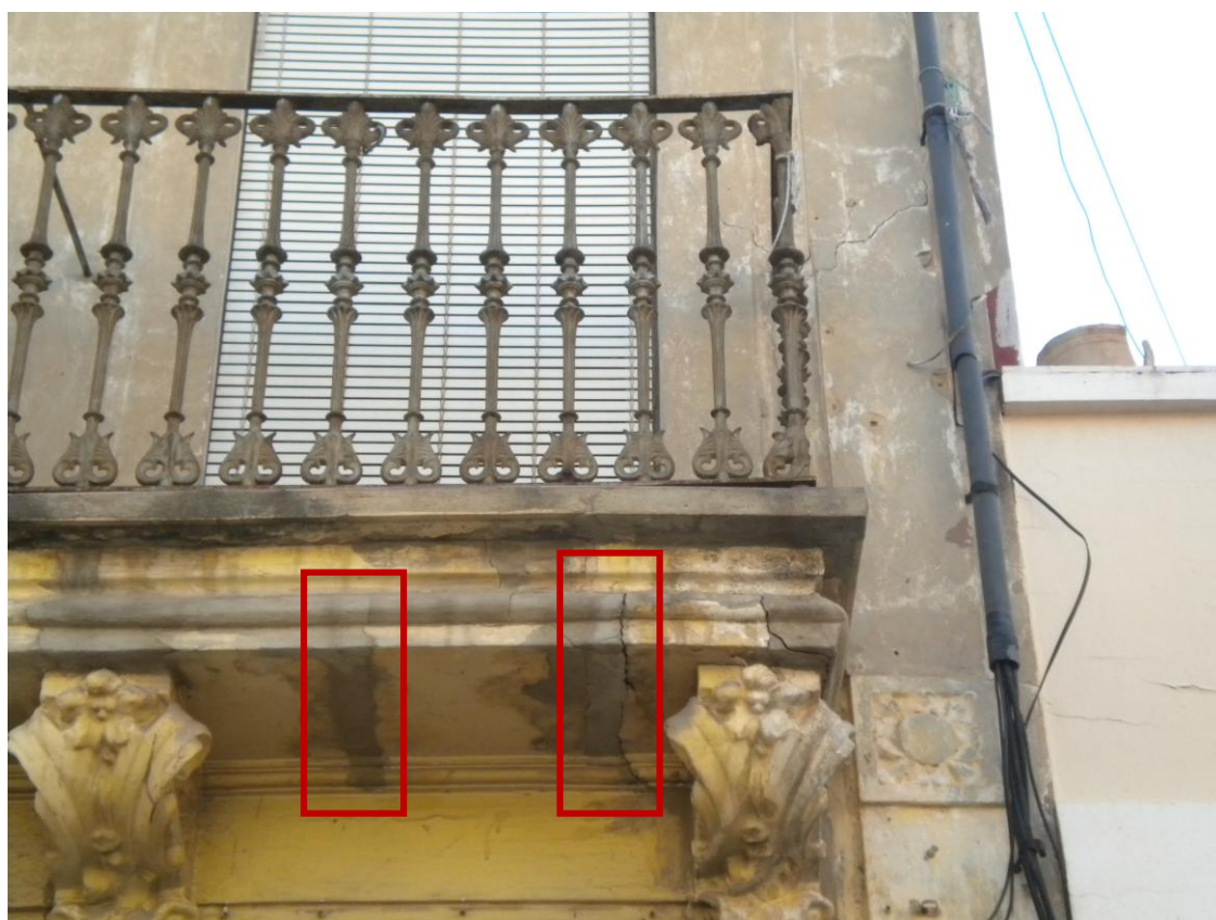
Esquerdas a la part dreta del balcó, s'aprecia la silueta de les armadures amb el color del morter de cement nou.
