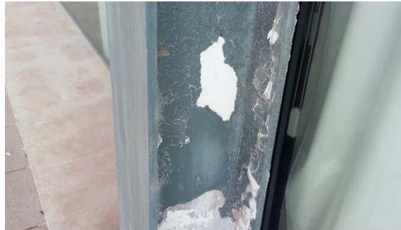
Figura 3-3. Deterioro de pinturas intumescentes en perfil HEB.
