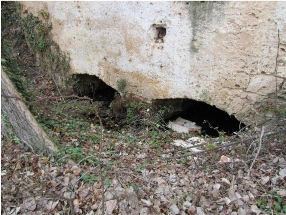
Entrada de agua al molino desde la acequia
