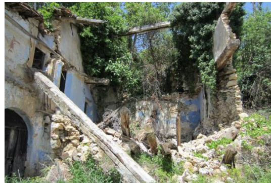
Parte del edificio derruido
