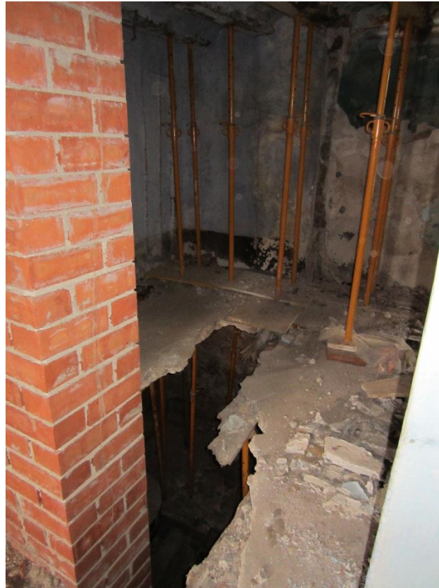
Forjado en lamentable estado
