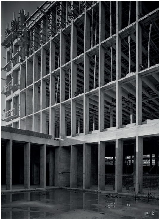
Figura 5. Embajada de Estados Unidos en Madrid. Izquierda: el edificio en construcción, vista desde el patio (1952). Derecha: planta tipo del bloque de oficinas, planta de la estructura y sección transversal.
