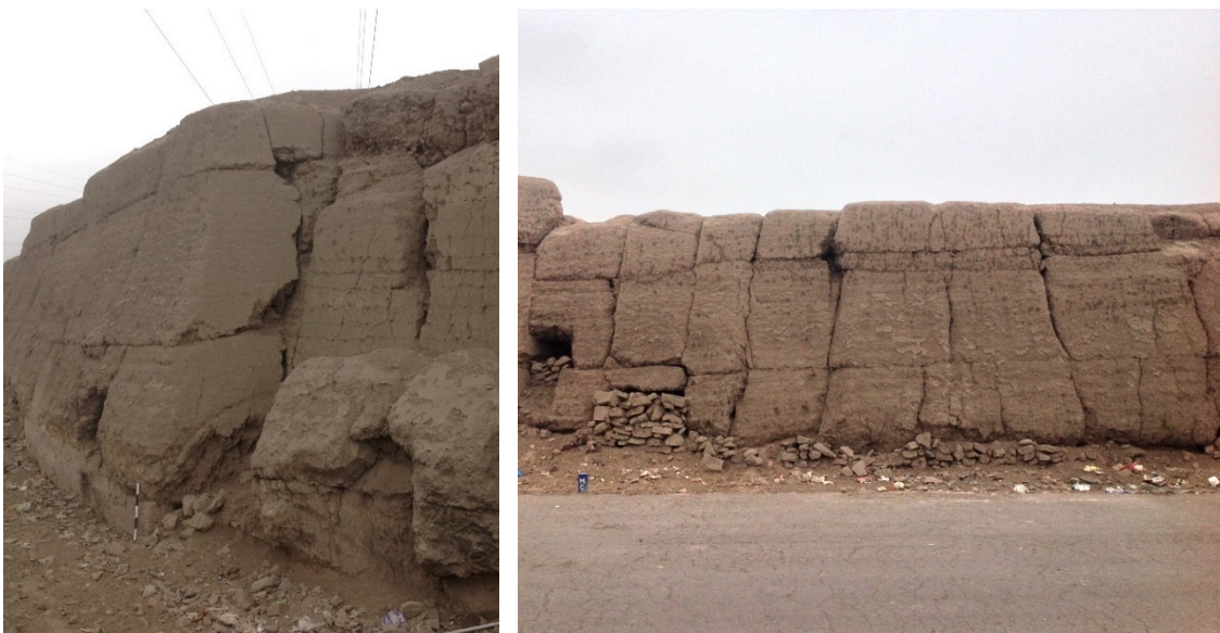
Figura 27. Vista de parte de la sección del muro que quedó expuesta debido al colapso parcial del segmento adyacente. Derecha: Vista en detalle de la adición de bloques a partir de un bloque ordenador. Fuente: Henry Eduardo Torres
