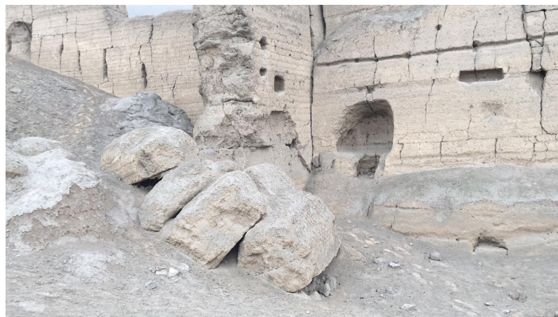
Figura 83. Pérdida parcial de muro por colapso.
