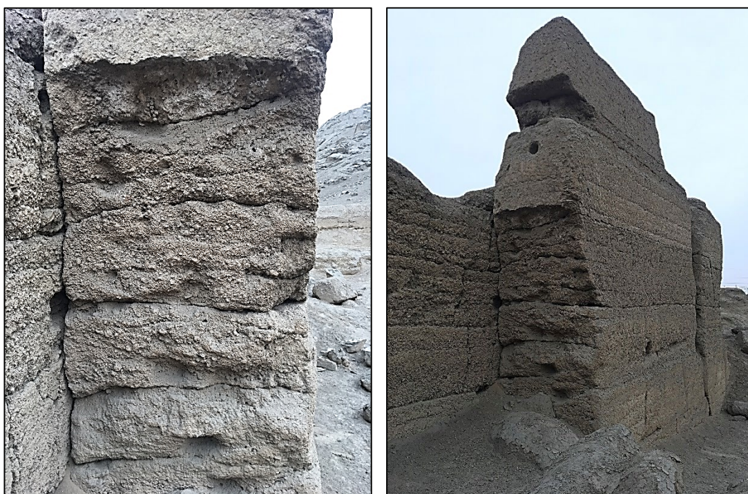
Figura 35. Capas de barro formando la estructura del muro que se pueden apreciar debido a un colapso, imágenes del sitio arqueológico Fortaleza de Campoy. Fuente: Henry Eduardo Torres.
