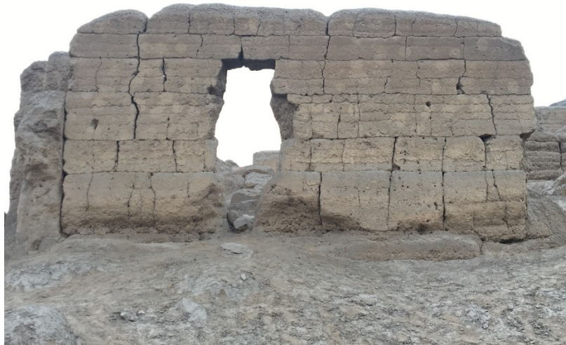
Figura 80. Muro seriamente afectado por cortes con pérdida de volumen estructural.
