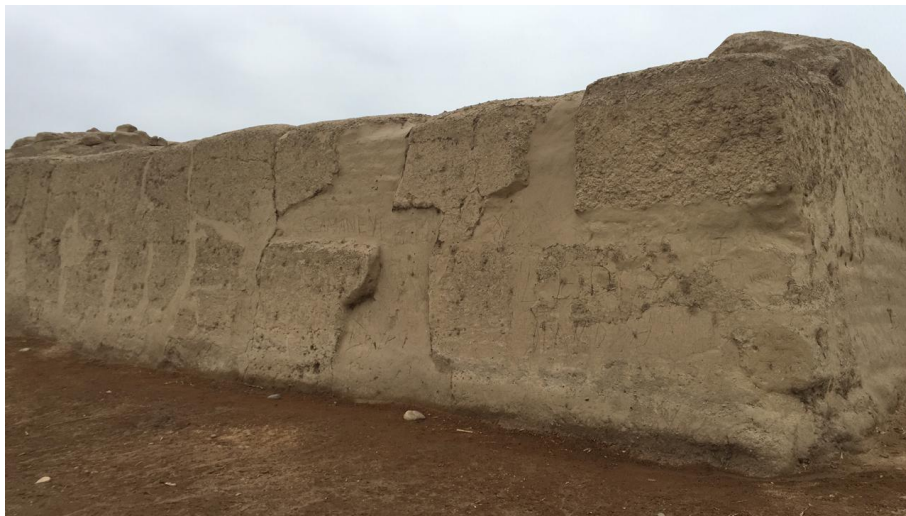
Figura 86. Muro intervenido con restituciones de mortero en grietas y probablemente en juntas entre muros segmentados. Fuente: Henry Eduardo Torres.
