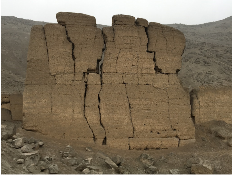
Figura 20. Vista de un muro muy afectado, esta vista permite analizar el fenómeno de colapso de este tipo de muros. Fuente: Henry Eduardo Torres.
