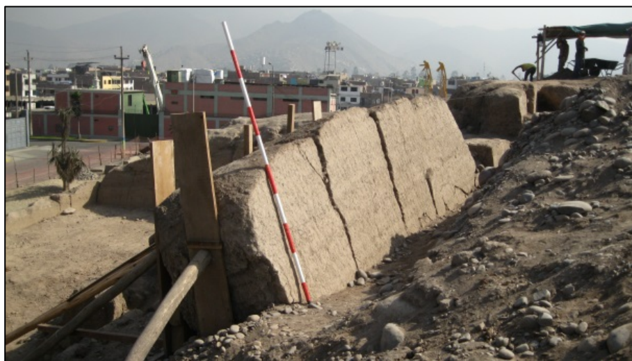
Figura 85. Asentamiento muro por pérdida de soporte de los rellenos constructivos. Fuente: Henry Eduardo Torres.
