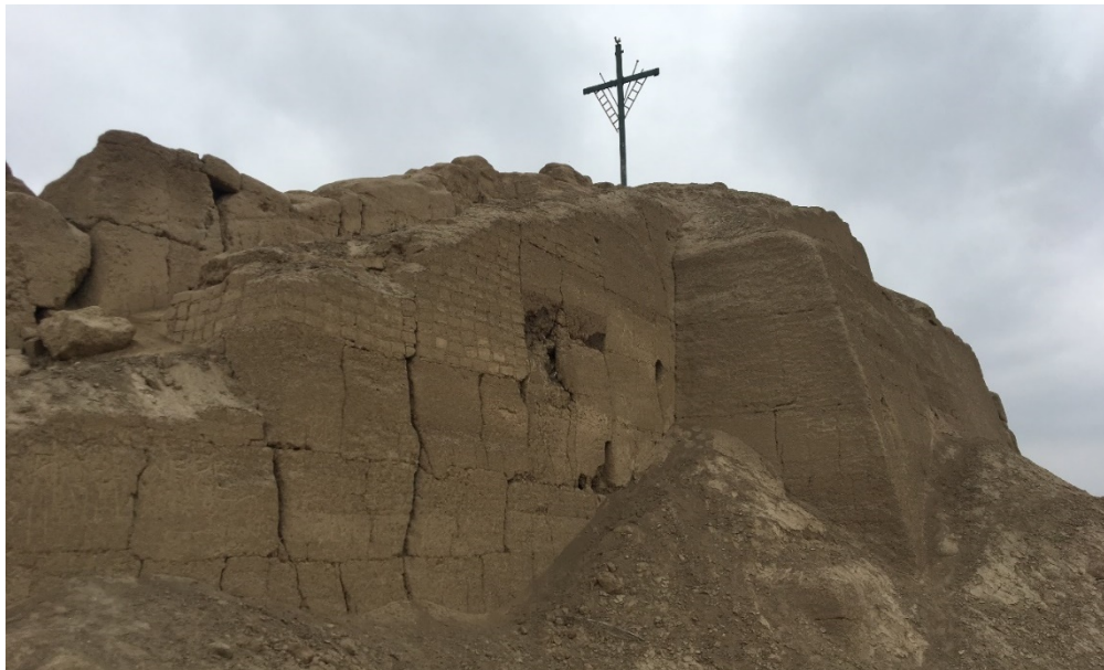
Figura 8. Vista de la Huaca desde suroeste. Se observan bloques constructivos y un contrafuerte en buen estado de conservación. Las uniones de los bloques se han acentuado producto de los sismos y algunos desprendimientos son los daños más visibles en la fachada. Fuente: Henry Eduardo Torres.
