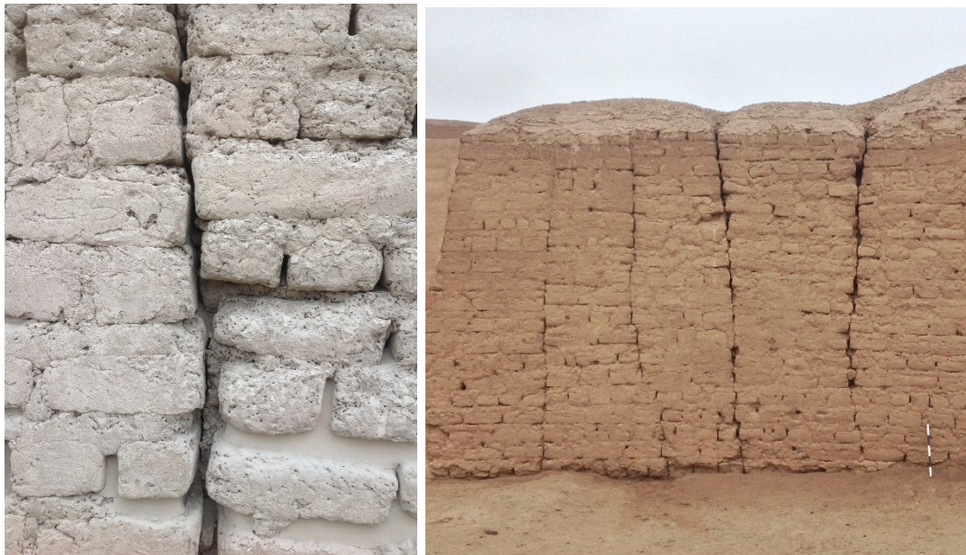
Figura 57. Izquierda: Vista en detalle de la junta entre segmentos de muros. Derecha: Segmentos cortos de un tramo de muro en buen estado de conservación. Santuario arqueológico de Pachacamac. Fuente: Henry Eduardo Torres.
