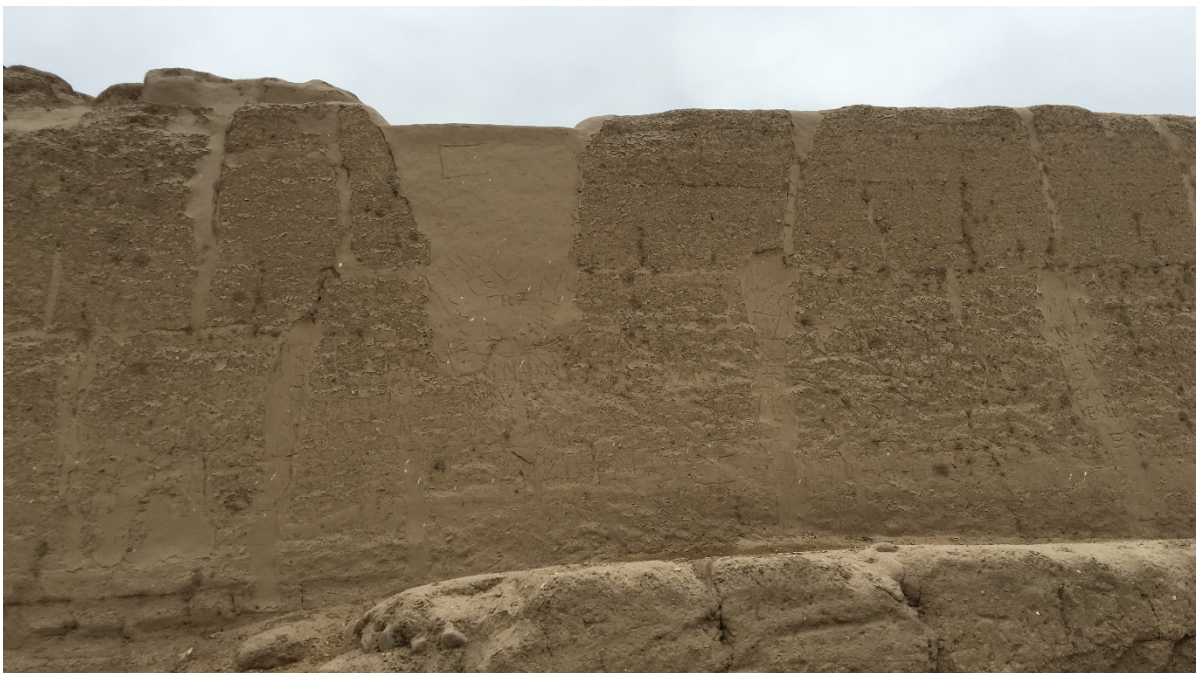
Figura 10. Muro conservado, se observan restituciones de mortero probablemente en grietas y juntas indistintamente. Fuente: Henry Eduardo Torres .
