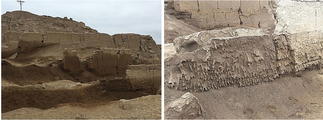
Figura 75. Muros fuertemente afectados por humedad, se observan diversos grados de afectación. Fuente: Henry Eduardo Torres.
