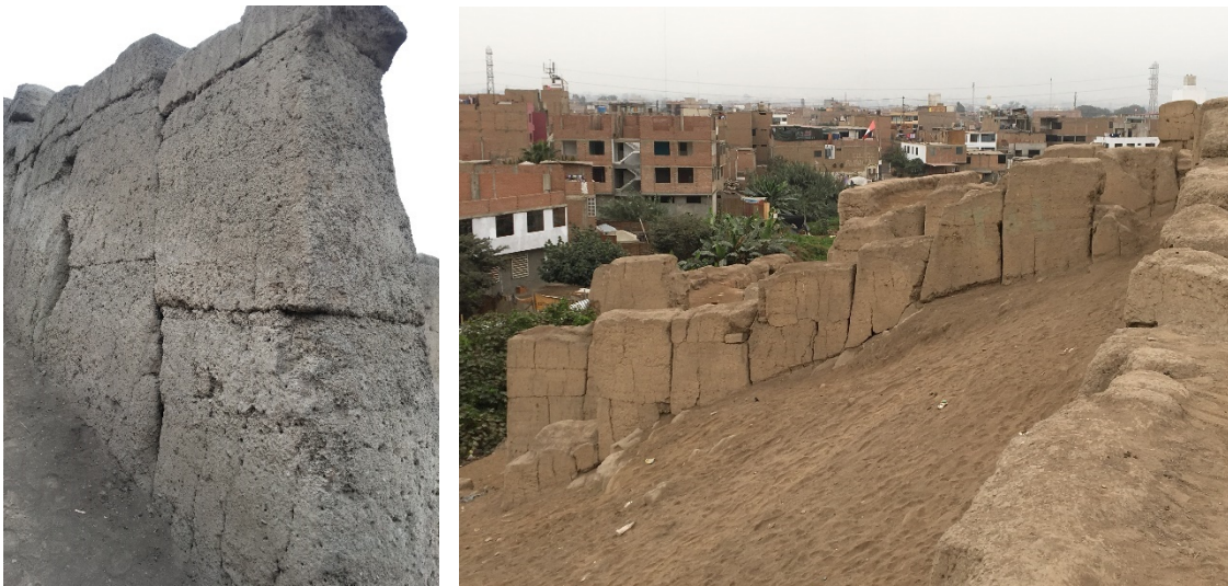
Figura 13. Muros construidos en terreno en pendiente formando por bloques independientes que sea adosan en planos inclinados. Fuente: Henry Eduardo Torres.
