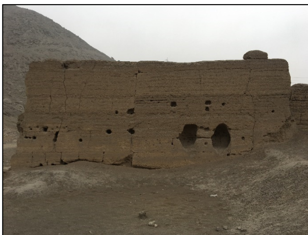
Figura 79. Perforación severa en un muro de tierra modelada. Fuente: Henry Eduardo Torres.
