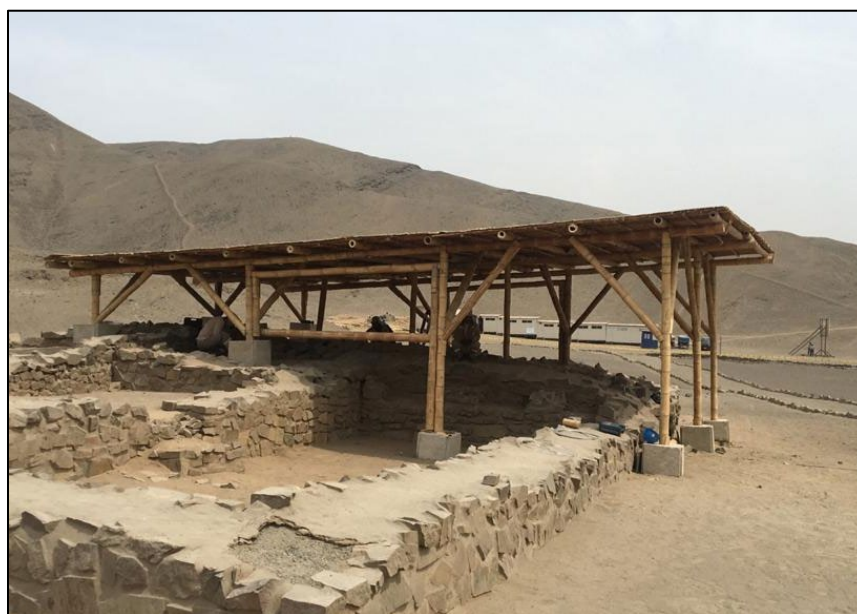
Figura 87. Cobertura permanente construida con bambú. Fuente: Henry Eduardo Torres Proyecto El Paraíso
