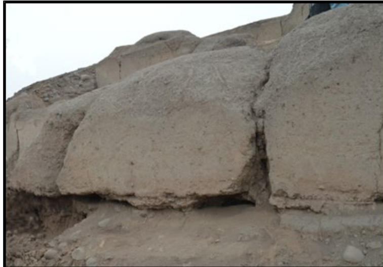
Figura 84. Muros con erosiones a nivel de la base y en la cabecera.
