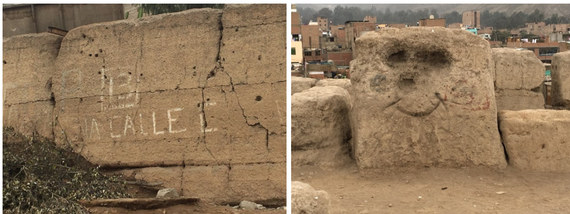
Figura 72. Grafitis y rayaduras en muros arqueológicos. Fuente: Henry Eduardo Torres.
