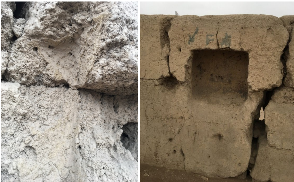
Figura 48. Izquierda: Restos del enlucido color claro dentro de la esquina interior de un nicho. Derecha: Nicho cortado en el muro. Fuente: Henry Eduardo Torres.
