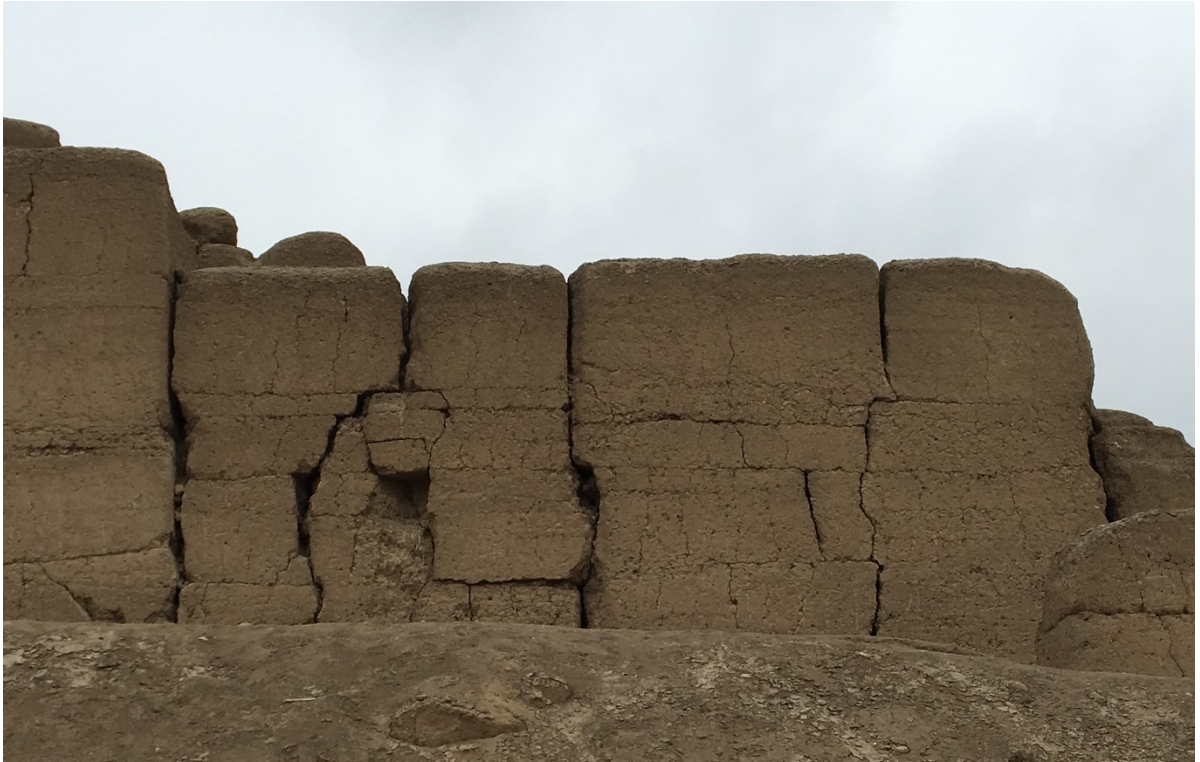
Figura 11. Vista de un muro con un tramo muy agrietado. Las juntas verticales no trababan adecuadamente los bloques y por tanto permitía un mayor desplazamiento entre ellos. Fuente: Henry Eduardo Torres.
