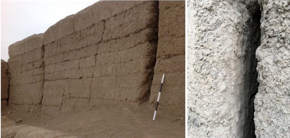
Figura 38. Muro de tierra modelada que muestra claramente las capas de barro con que fue conformada, se aprecia además la forma cóncava que toman producto de la colocación sucesiva de estas. Izquierda: Interior de una junta entre bloques donde se aprecia las marcas de alisado de la superficie. Fuente: Henry Eduardo Torres. Sitios arqueológicos: Palacio de Oquendo y Tambo Inga.
