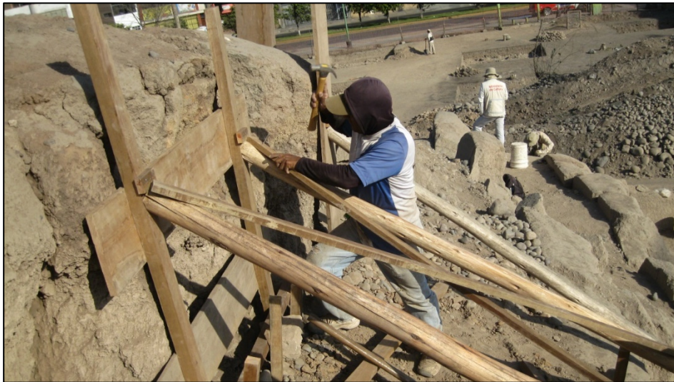
Figura 88. Apuntalamiento con todas las partes correctas, puntales, tensores y estacas de madera. Fuente: Henry Eduardo Torres Proyecto Huaca Bellavista.
