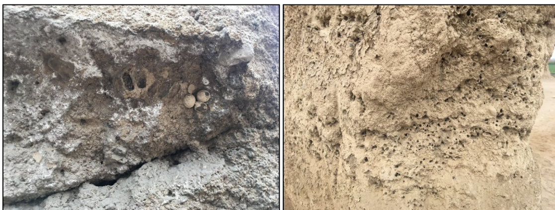
Figura 73. Colonización biológica en muros.
