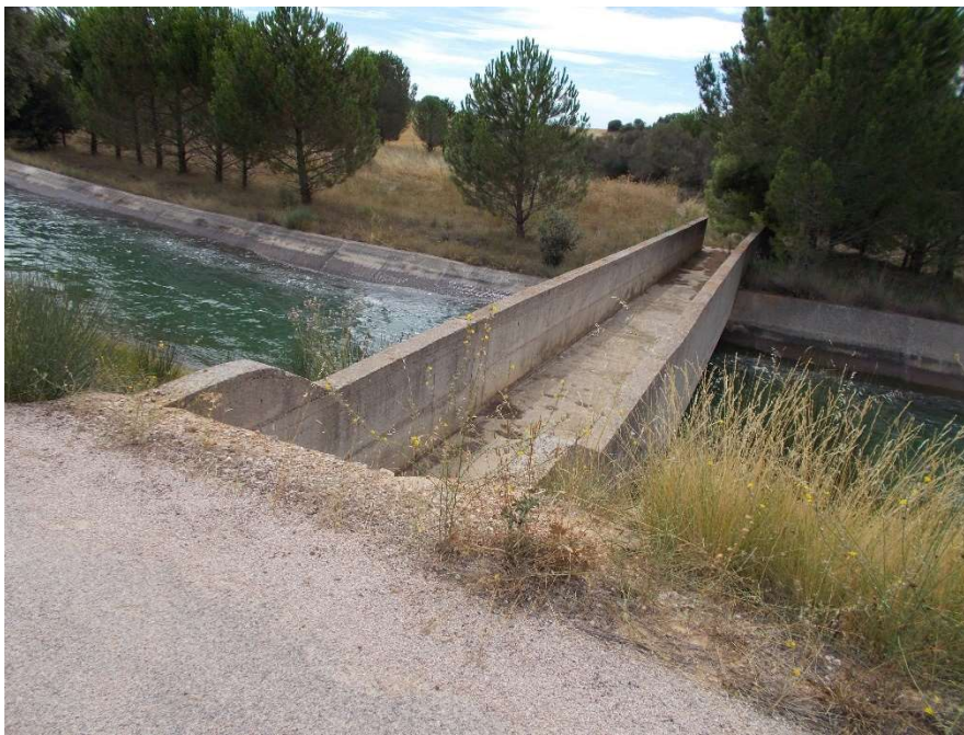
Ilustración 17. Arroyo del Juncosillo atravesando la vía de servicio y el canal ATS en el PK 91+000
