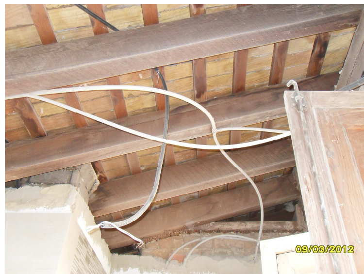
En esta fotografía tomada desde la planta inferior a la cubierta (5ª planta), se aprecian los pares originales del elemento así como los cañizos que se ven al fondo de la imagen
