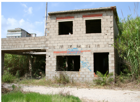
Imagen 51: Construcción abandonada. Fotografía propia.
