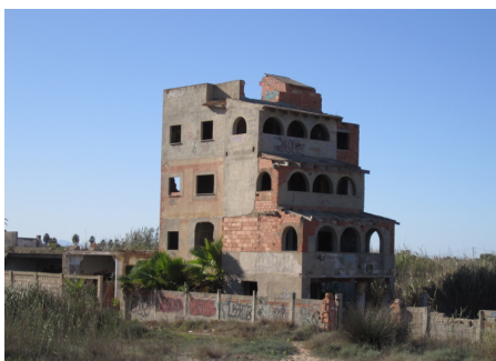
Imagen 53: Construcción abandonada 3. Fotografía propia.
