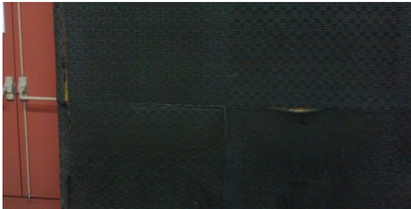
Figura 2.1.3.2.1.- PARED CON MATERIAL ACUSTICO DEFECTUOSO
