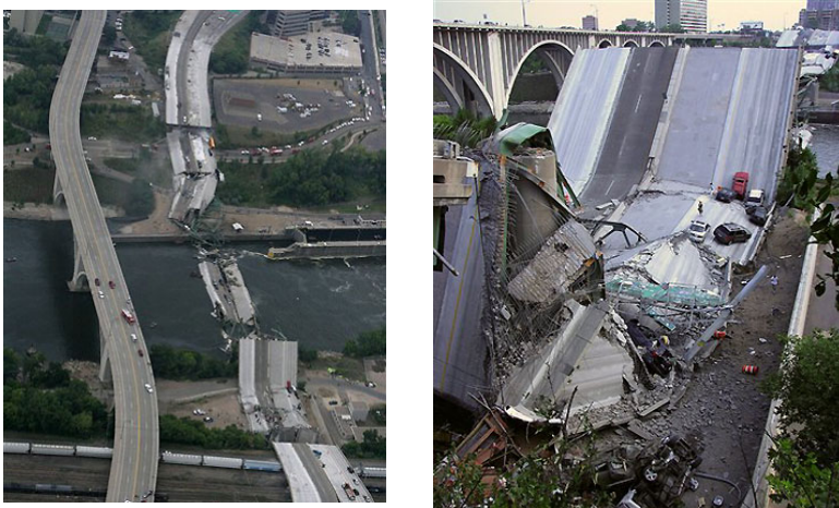
Figura 1. Colapso de un puente sobre el río Missisipi en Mineapolis, USA. ( www.nytimes.com )
