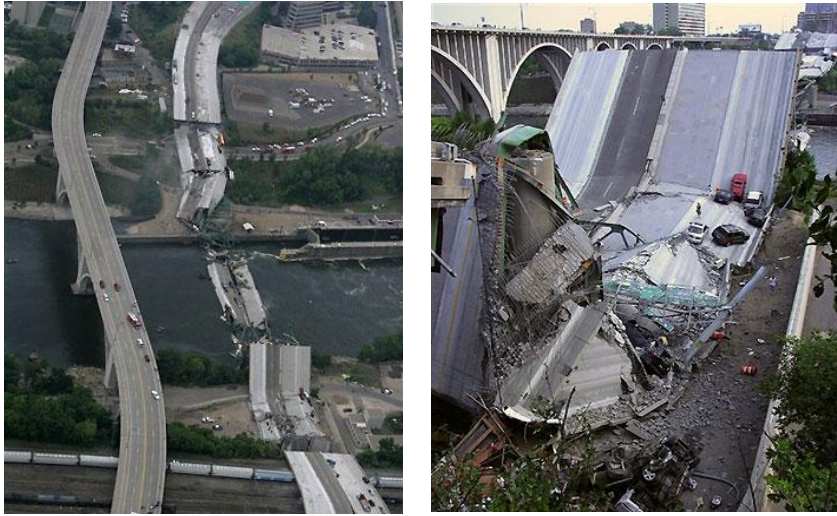
Figura 1.2 Colapso de un puente sobre el río Missisipi en Mineapolis, USA. (www.nytimes.com)
