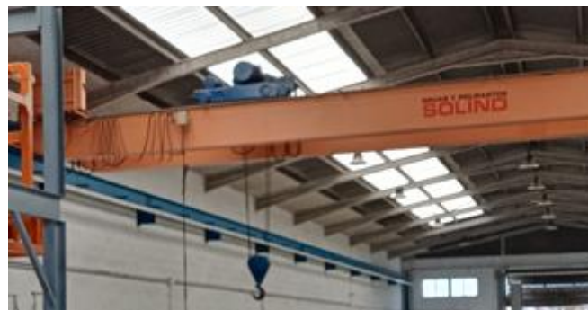
Imagen 20. Puentes grúa naves 1, 2 y 3 Fuente: Datos empresa. Elaboración propia
