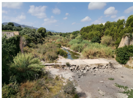
Figura 9. Estat actual del sífó, executat segons projecte de Lacorte, en estat de desús
