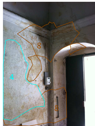
A . (4) Distacco di tinteggiatura e (8) Macchie
