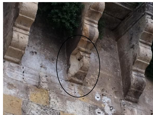
Fig.16 Soggezione del balcone (Palazzo Santoro-Bronzini)
