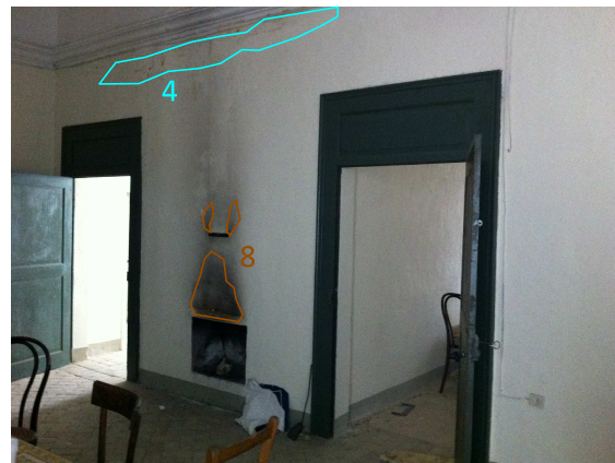
B . (4) Distacco di tinteggiatura e (8) Macchie
