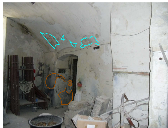
B. (4) Distacco di tinteggiatura e (8) Macchie
