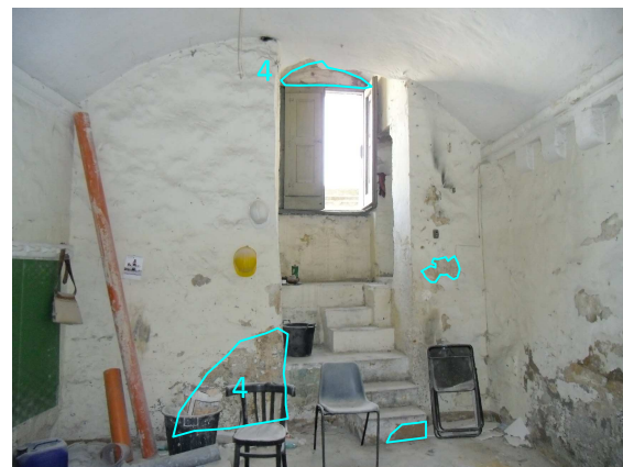
C. (4) Distacco di tinteggiatura
