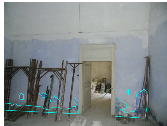
D. (4) Distacco di tinteggiatura
