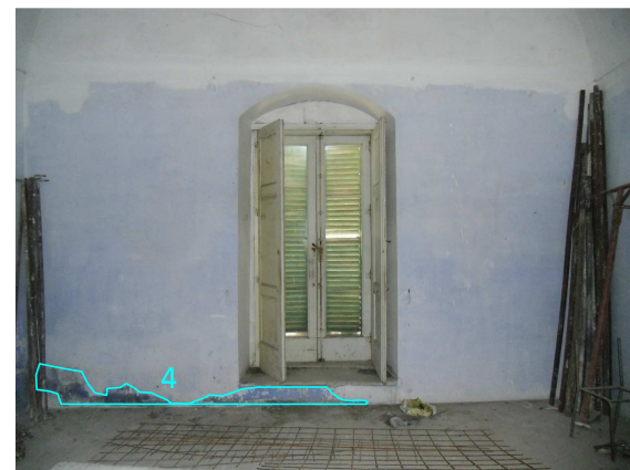
C. (4) Distacco di tinteggiatura
