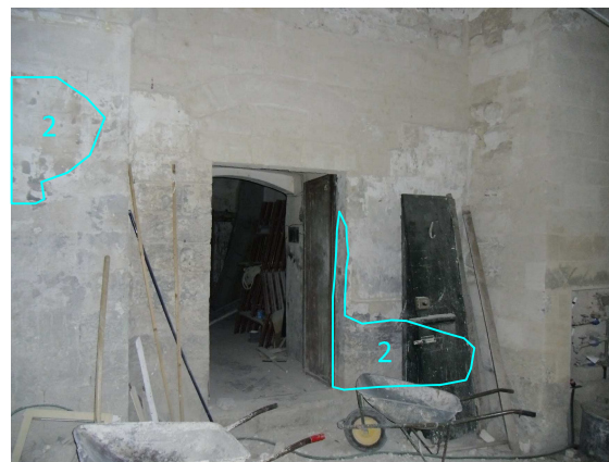
D. (4) Distacco di tinteggiatura
