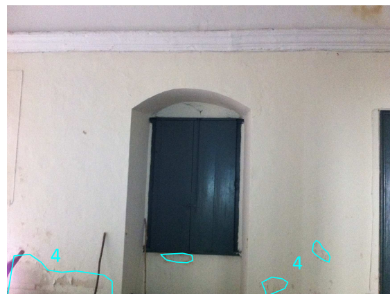
D . (4) Distacco di tinteggiatura
