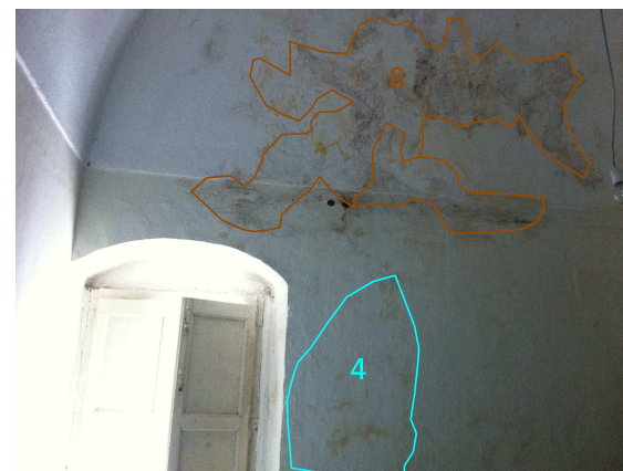
B. (4) Distacco di tinteggiatura e (8) Macchie
