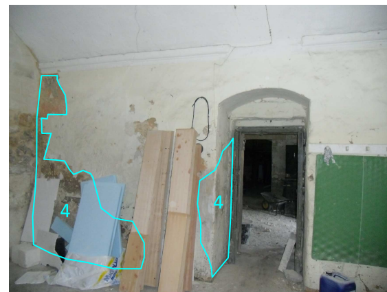
D. (4) Distacco di tinteggiatura
