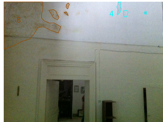
B. (4) Distacco di tinteggiatura e (8) Macchie
