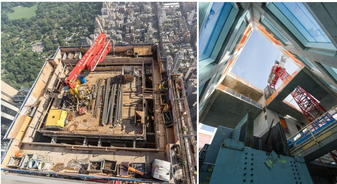
Imagen 44. Vista aérea de la pluma en el núcleo. Fuente: Concrete homes; 432 Park Avenue (Rehana, 2015) Imagen 45. Vista interior del amortiguador de masa y de la pluma. Fuente: Concrete homes; 432 Park Avenue (Rehana, 2015)
