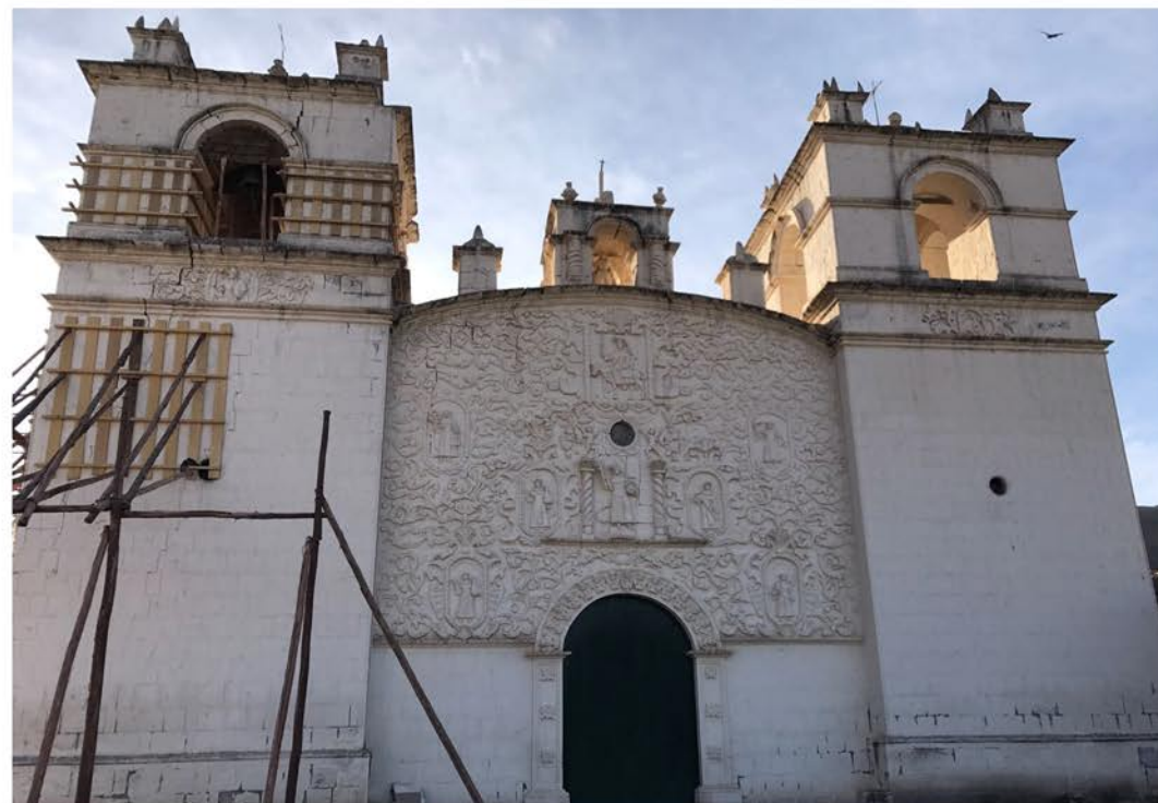
Fachada de pies del templo de la Inmaculada Concepción de Yanque, con el muro tapiz al centro. Archivo propio.
