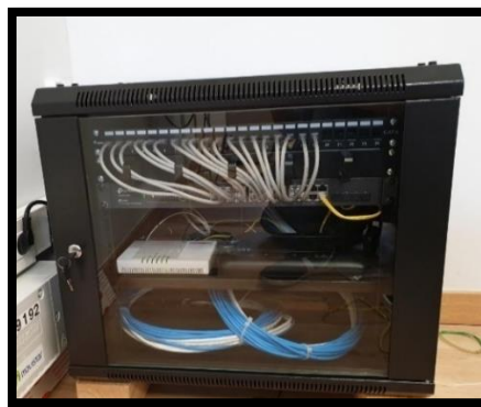
Figura 3.8. Rack de comunicaciones.
