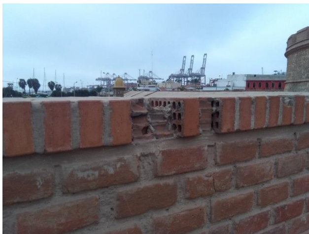
Figura 122: Murete de ladrillo erosionado por la humedad del mar. Fuente: Archivo fotográfico personal, 2020.
