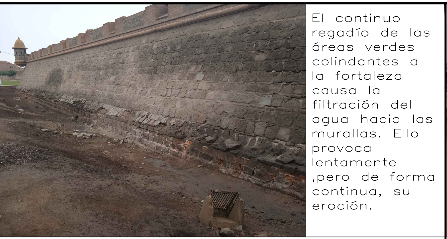
1.- HUMEDAD POR FILTRACIÓN
