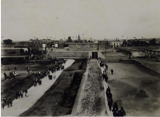
Figura 38: Obras de restauración de las murallas. Fuente: Archivo del arquitecto Víctor Pimentel, 2018.
