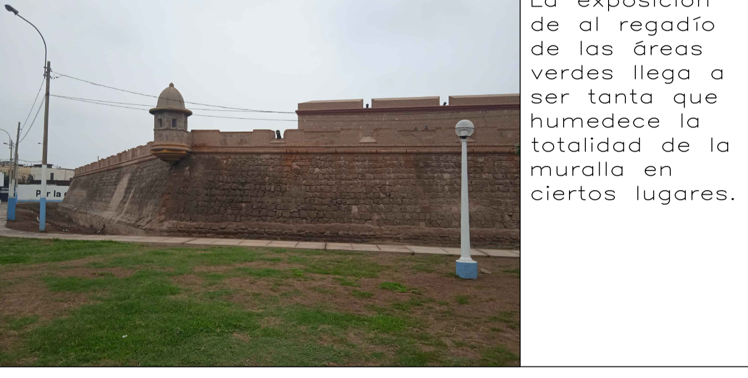
8.- HUMEDAD POR FILTRACIÓN
