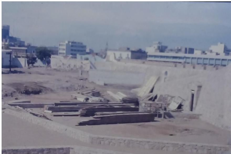
Figura 104: Restauración de una rampa de ascenso (1974) Fuente: Archivo del arquitecto Víctor Pimentel, 2018.
