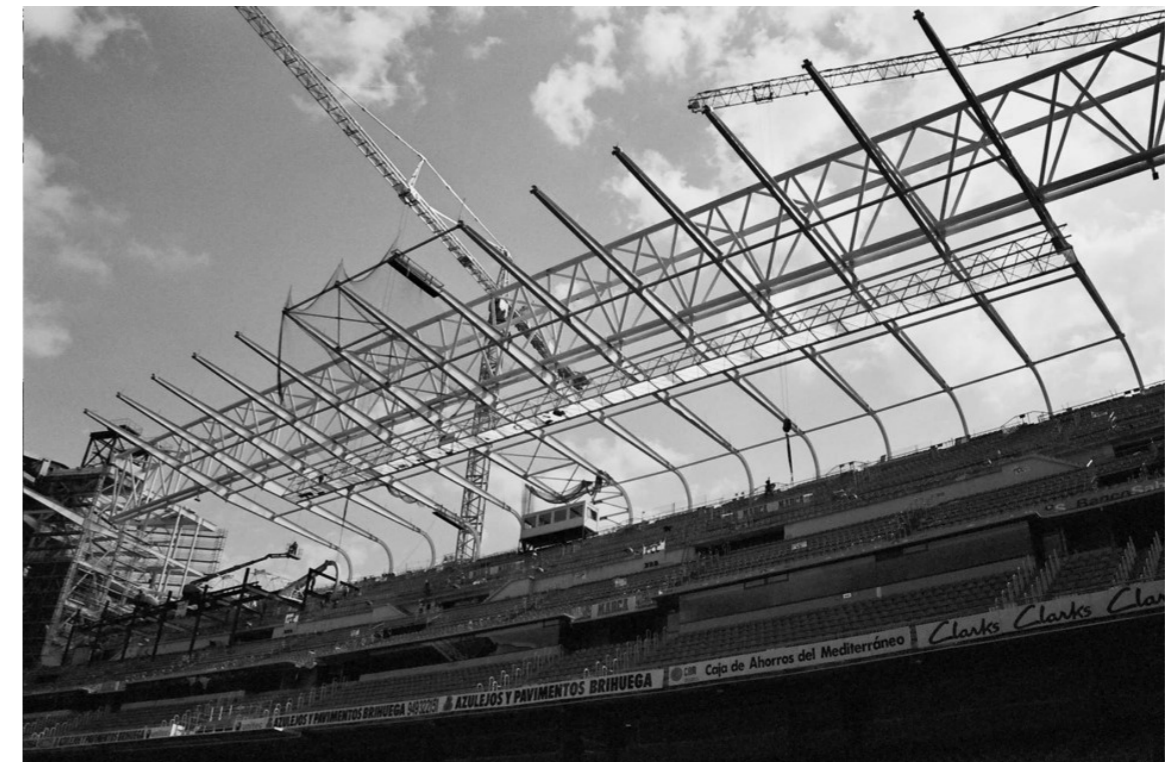
Figura 82. Vista interior de la cubierta este del Santiago Bernabéu durante la reforma de 2002.
