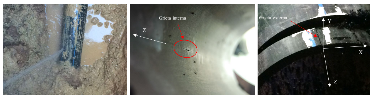
Figura 3.- Muestra nº1. Fuga de agua en calle 2, en la tubería de PE 100, DN-110
